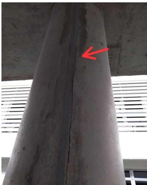
Figura 07: fissura próxima a junta de dilatação do pilar
