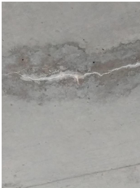
Figuras 12 e 13: Eflorescência na Laje
