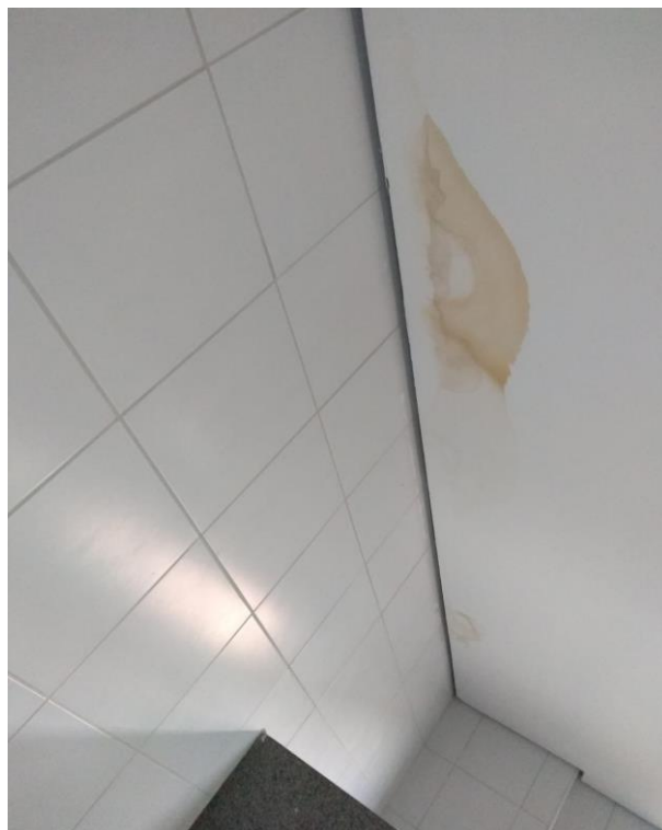
Figuras 20 e 21: Manchas nos Banheiros
