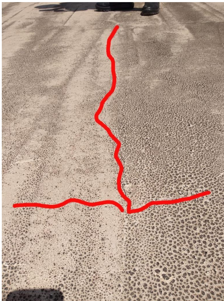
Figura 11: Fissuração na laje da passarela
