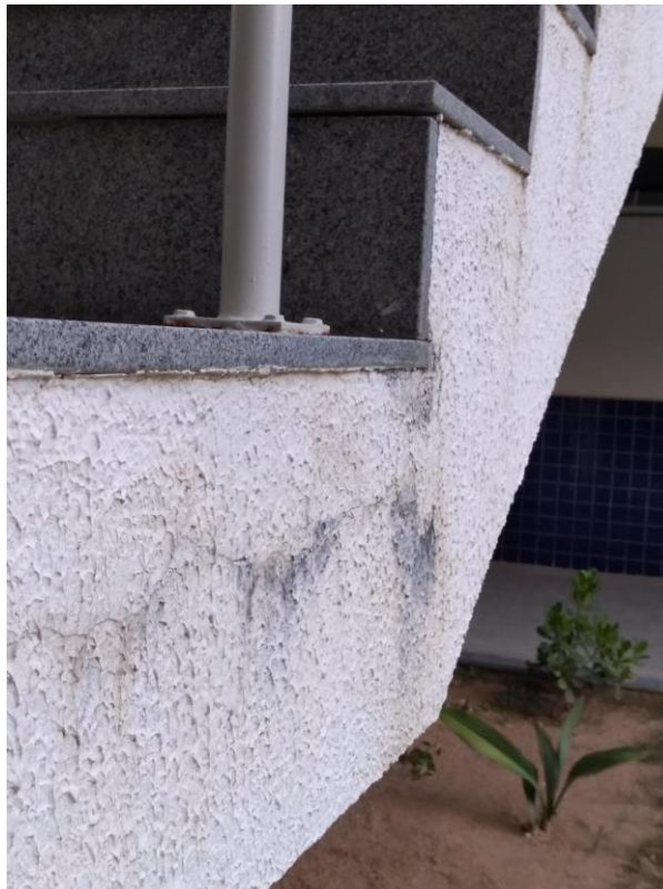
Figura 19: manchas nas escadas
