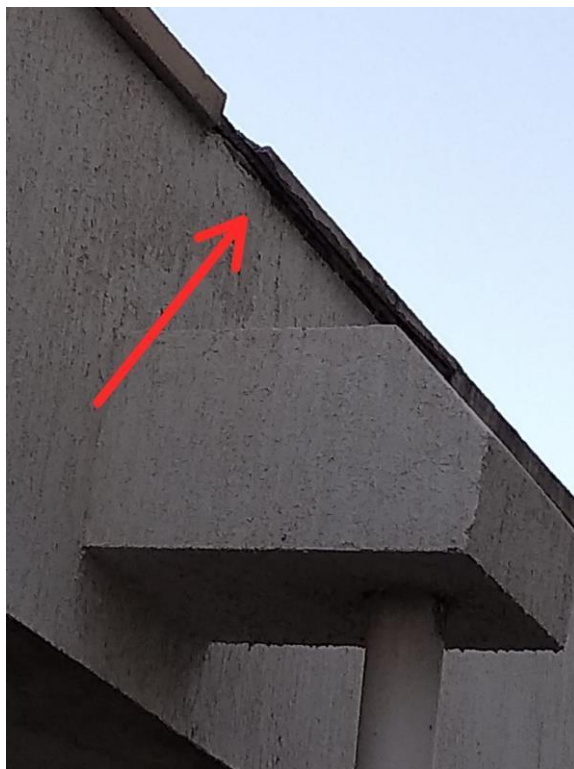
Figura 16 e 17: Corrosão e Deterioração do Chapim
