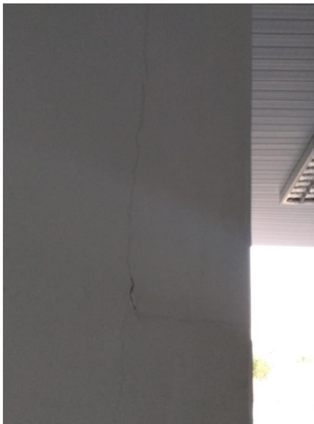
Figura 14: Fissura em revestimento do pilar.
