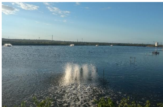
Figura 28 – Aerador de palheta em funcionamento.
