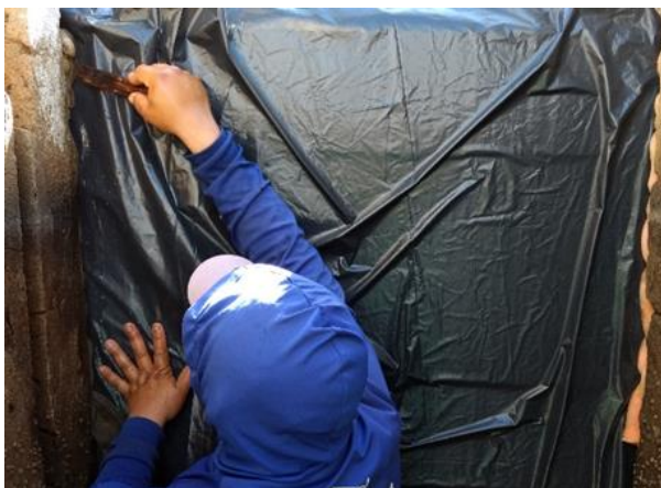
Figura 7 – Vedação da comporta com auxílio de sacos plásticos.
