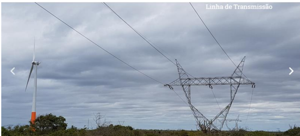
Figura 15 – Linha de transmissão do Complexo Eólico em Icapuí/CE
