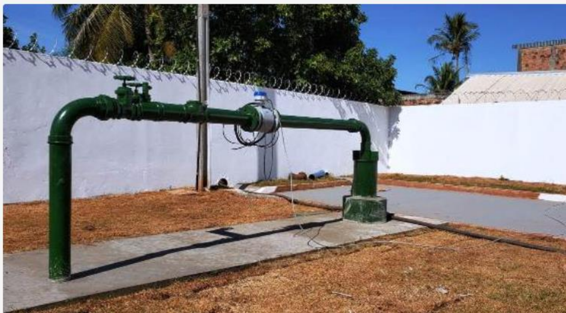
Figura 5 – Captação em poço profundo.
