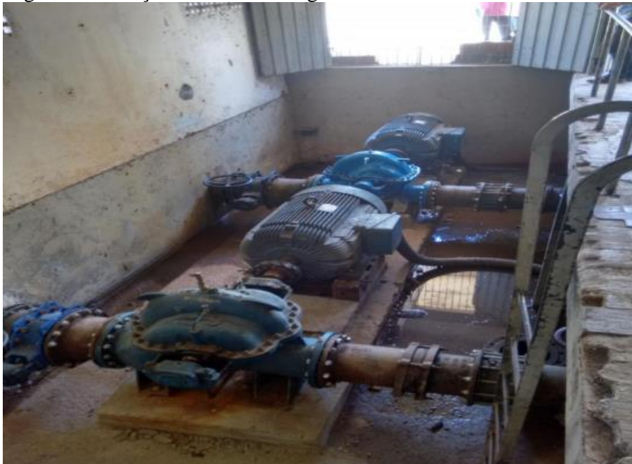
Figura 7 – Estação elevatória de água bruta
