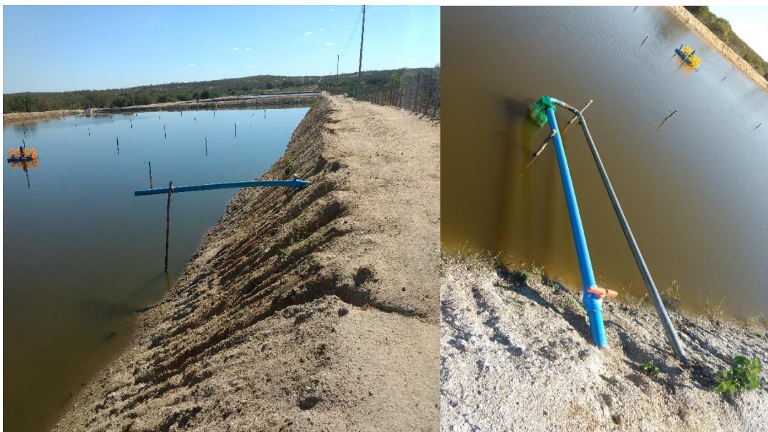
Figura 2 – Tubulação de abastecimento dos viveiros da Fazenda Aconcheço.
