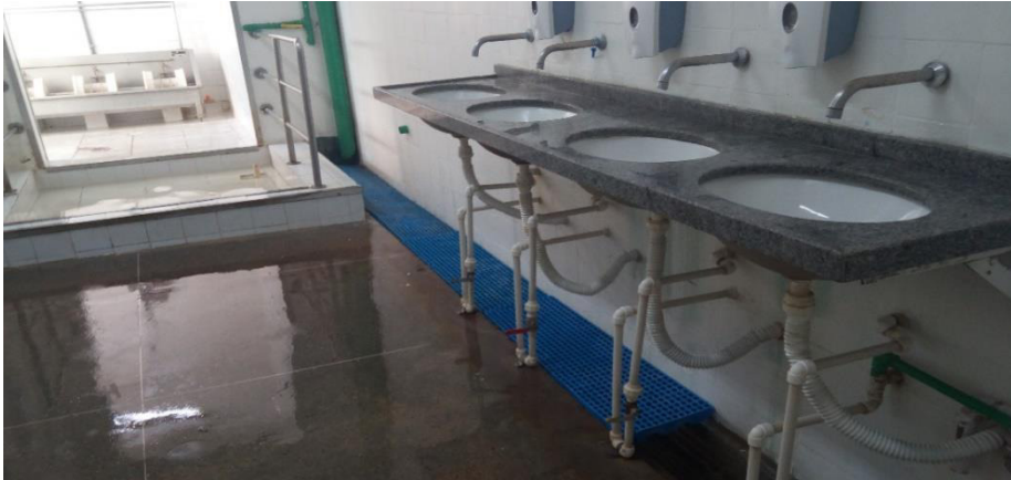
Figura 4 - Gabinete de higienização.
