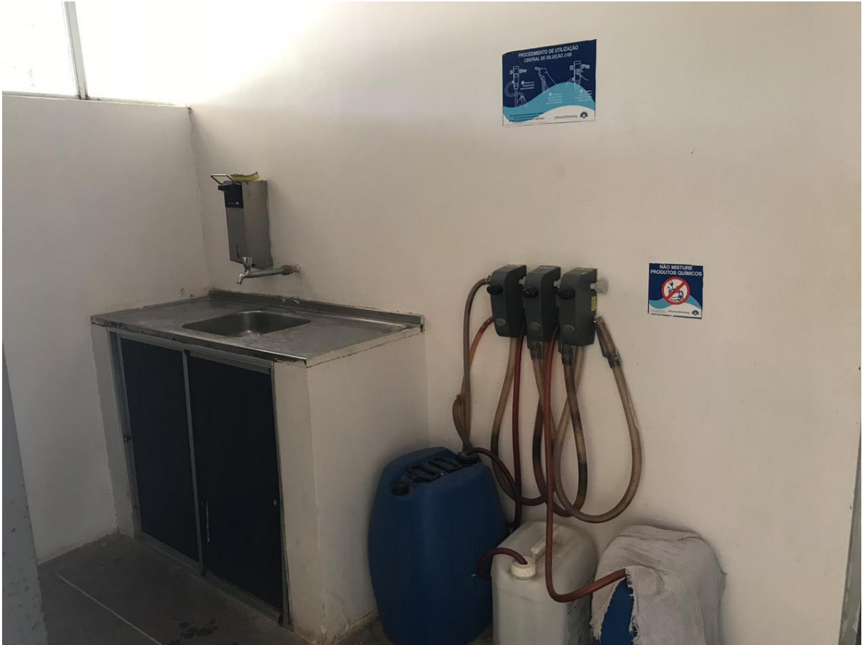
Figura 2 - Gabinete de higienização.
