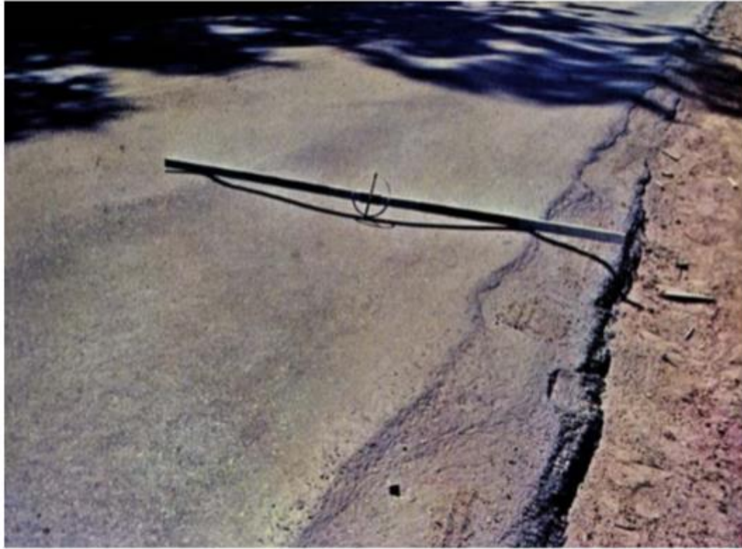
Figura 8 – Afundamento de trilha de roda
