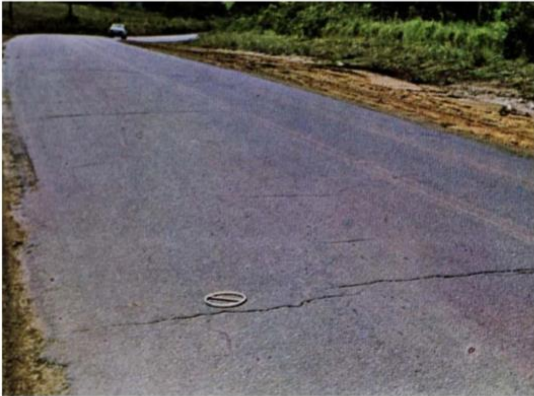
Figura 4 – Trinca isolada - transversal
