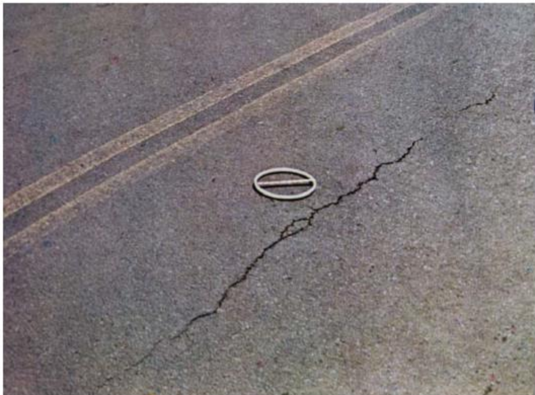
Figura 5 – Trinca isolada - longitudinal
