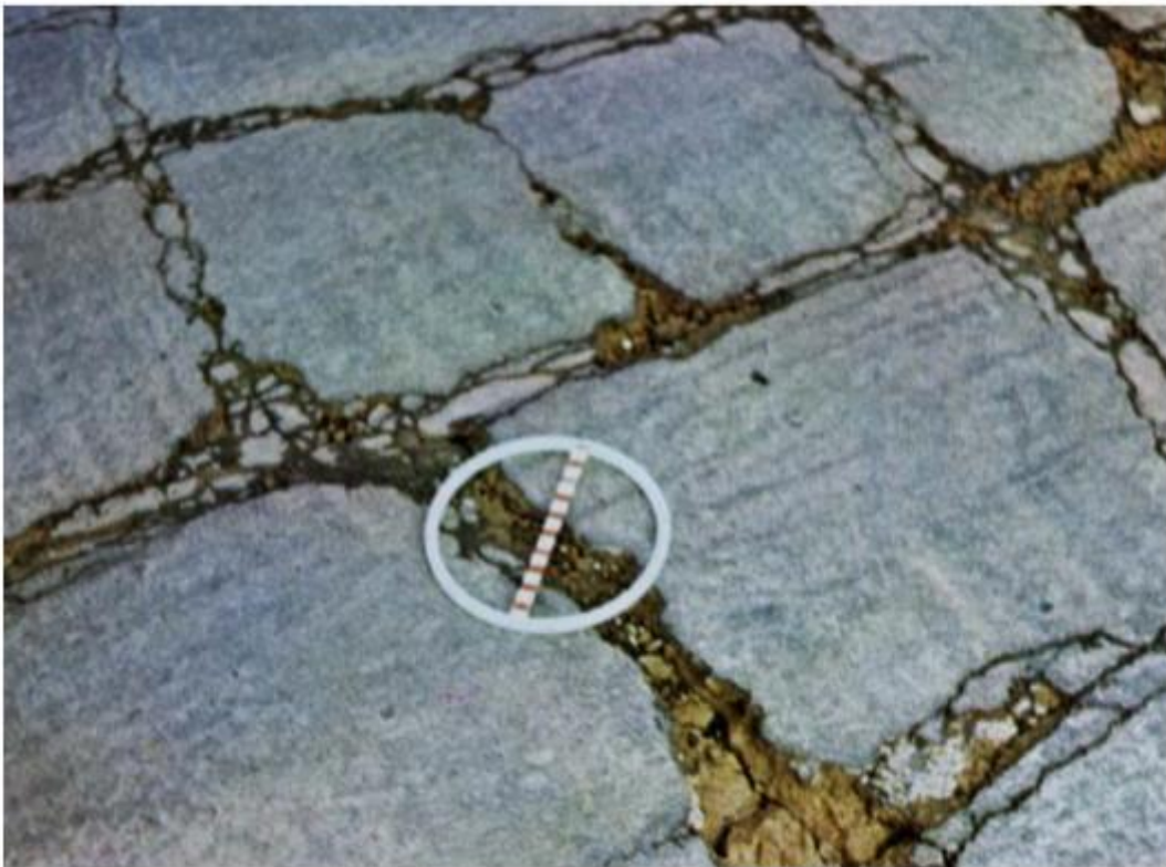
Figura 7 – Trinca interligada – tipo bloco
