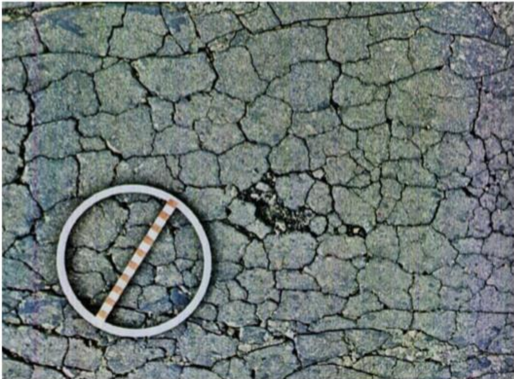
Figura 6 – Trinca interligada – tipo jacaré
