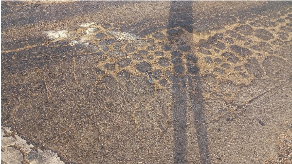
Figura 23 – Defeito de “Couro de Jacaré” BR 116
