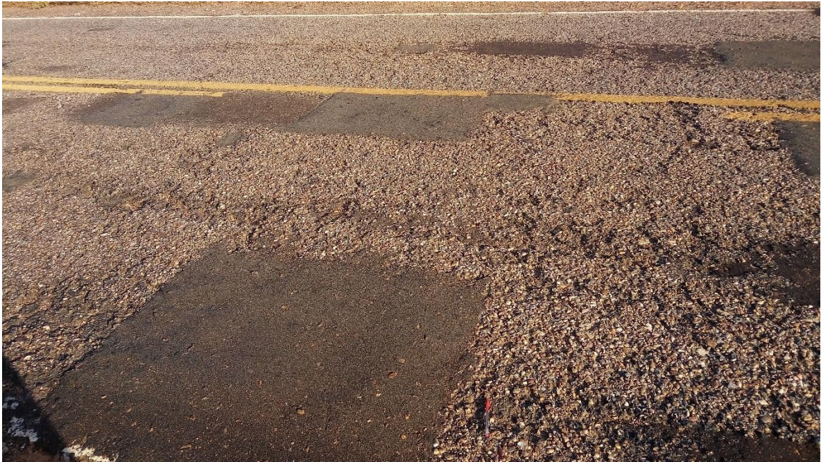
Figura 28 – Remendos e Desgastes em trecho da CE 263
