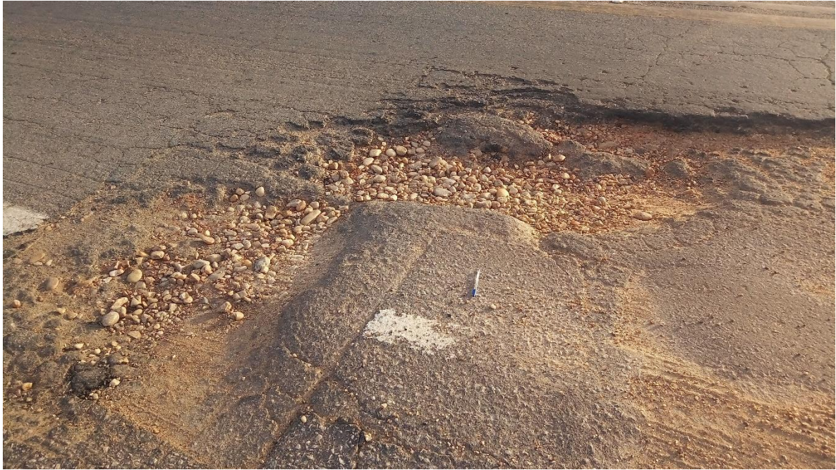
Figura 19 – Defeitos diversos em trechos da BR 116
