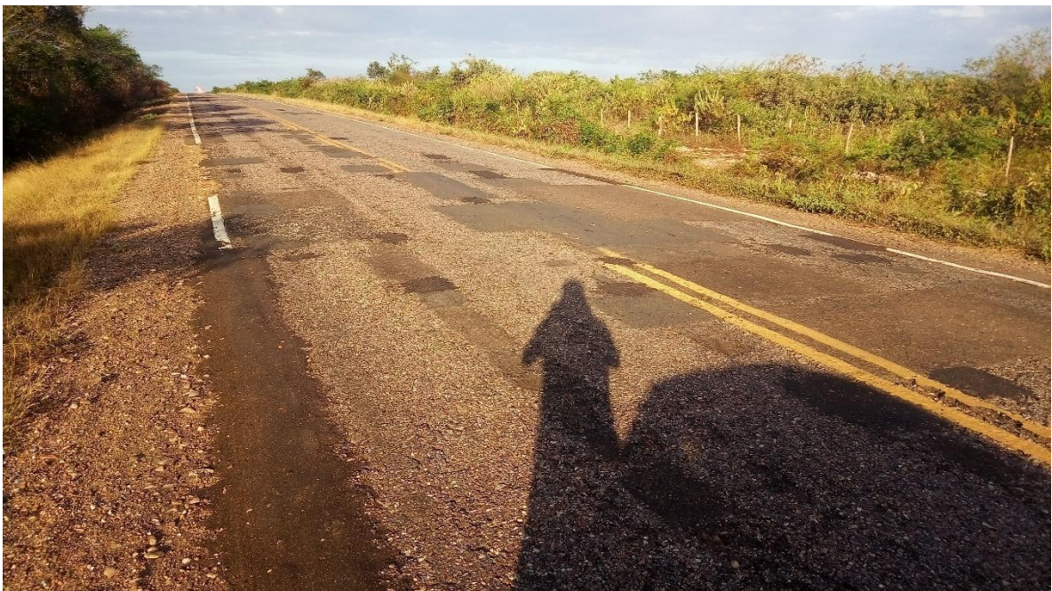
Figura 25 – Remendos em trecho da CE 263
