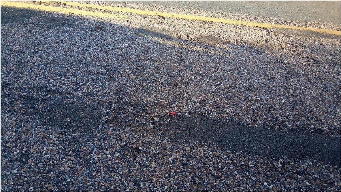
Figura 26 – Desgastes do pavimento em trecho da CE 263
