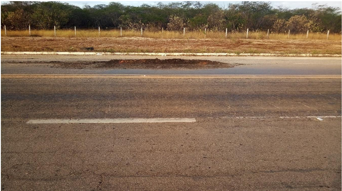
Figura 20 – Afundamento em trecho da BR 116
