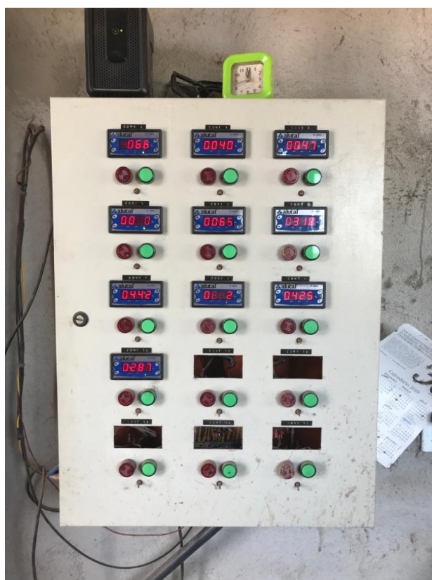
Figura 21 - Painel de Controle das Temperaturas
