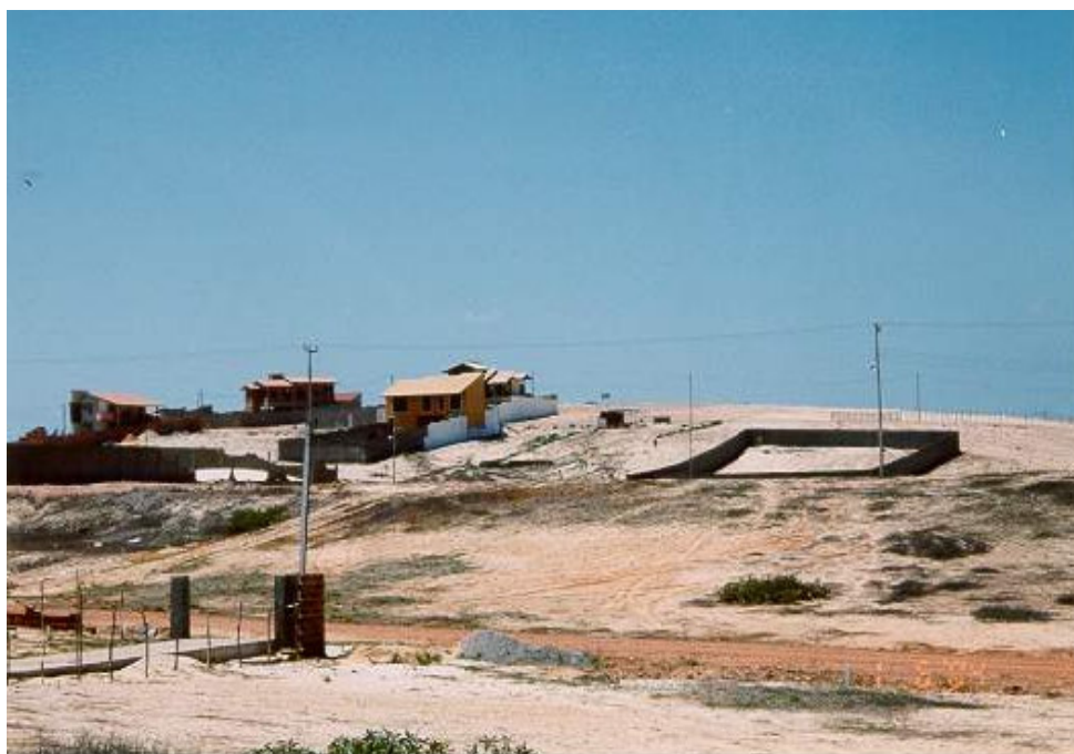
FOTO 6.3: Canteiro de obras e terrenos preparados para futuras construções, com vias de acesso ainda sem pavimentação – Porto das Dunas. FONTE: Rosa Alice Rodrigues (2004).
