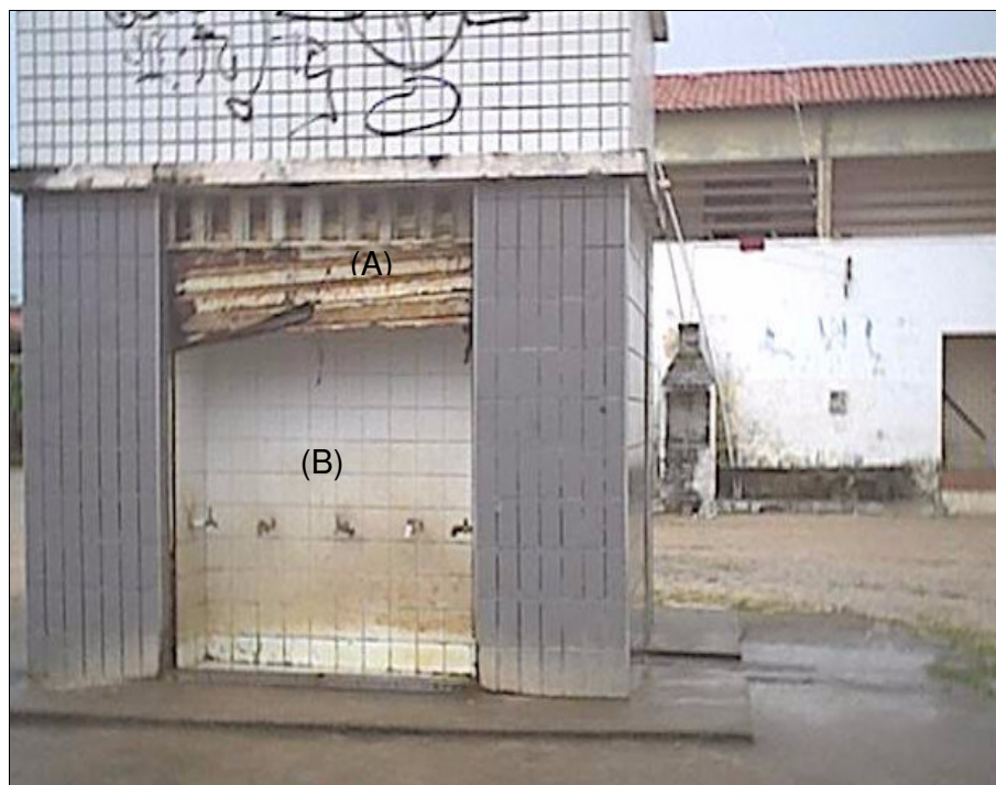
FOTO: 6.5 - Chafariz em precárias condições de uso – Praia do Iguape.
