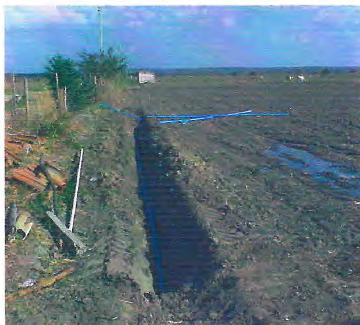
FIGURA 7 - Instalação dos equipamentos de irrigação.
