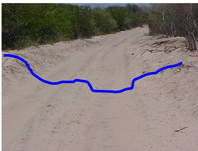
FIGURA 2.34: ESTRADA COM ALTO NÍVEL DE SEVERIDADE (AREIÕES)
