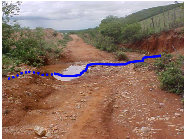
FIGURA 2.25: EXEMPLO DE BURACOS (ALTO NÍVEL DE SEVERIDADE)
