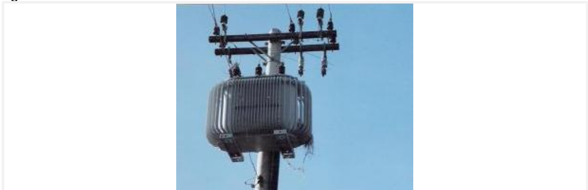
Figura 4 – Transformador instalado ao ar livre
