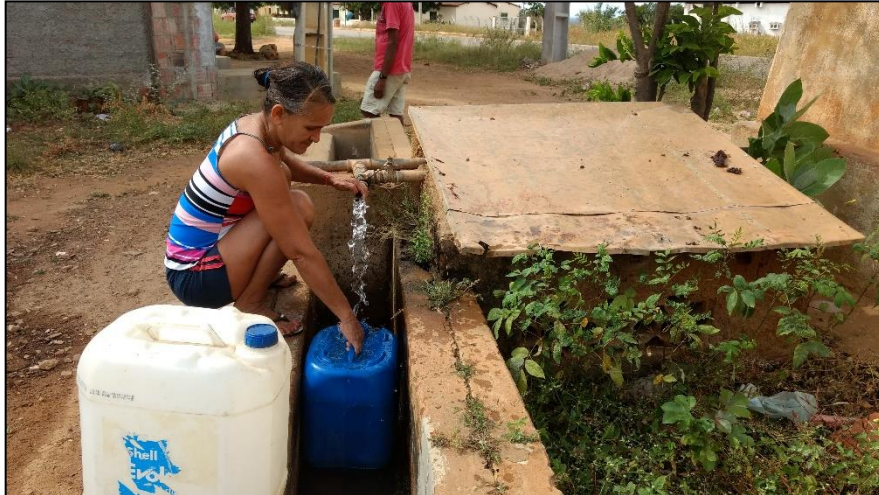
FFigura 85 - Coleta de água diante de problemas na encanação do sistema de abastecimento comunitário em Soledade – Apodi - RN. Fonte: acervo da pesquisa (2018)
