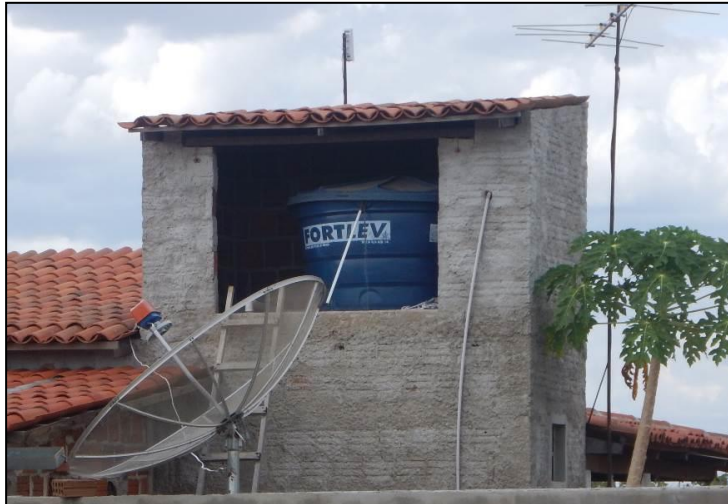
FFigura 55 - Caixa d'água de polietileno: sistema de armazenamento mais frequente. Fonte: acervo da pesquisa (2018)
