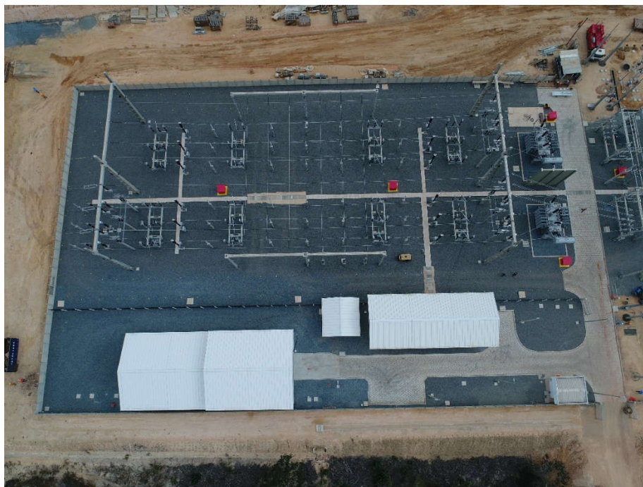
Figura 23 - Vista aérea da subestação coletora Cacimbas.
