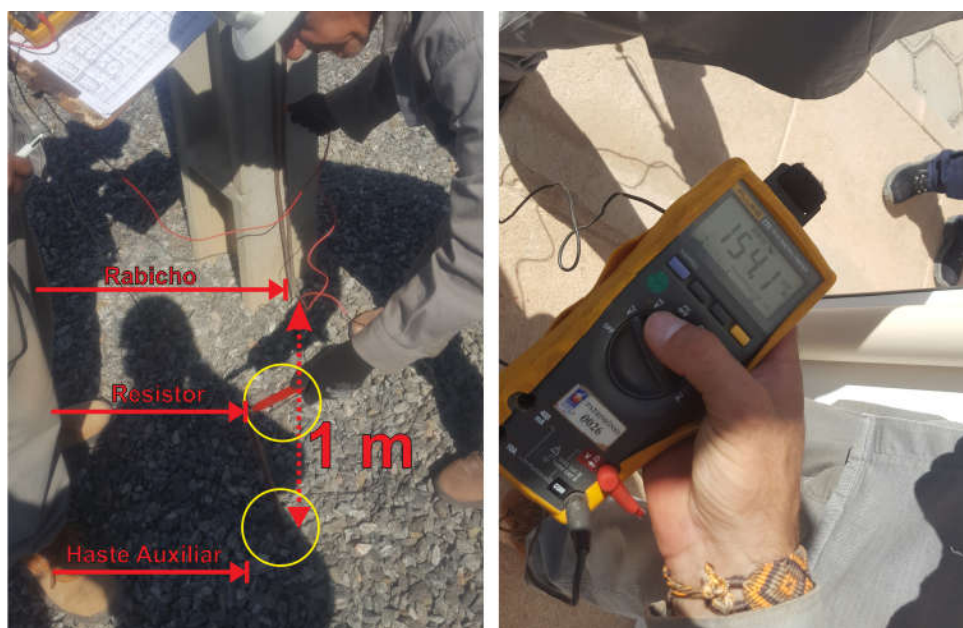
Figura 38 - Medição dos potenciais de toque. A esquerda procedimento de medição e a direita valor medido.
