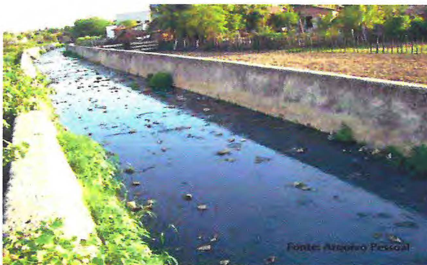
Figura 4-Canal de lançamento de esgotos domésticos da cidade de Pentecoste-Ce.
