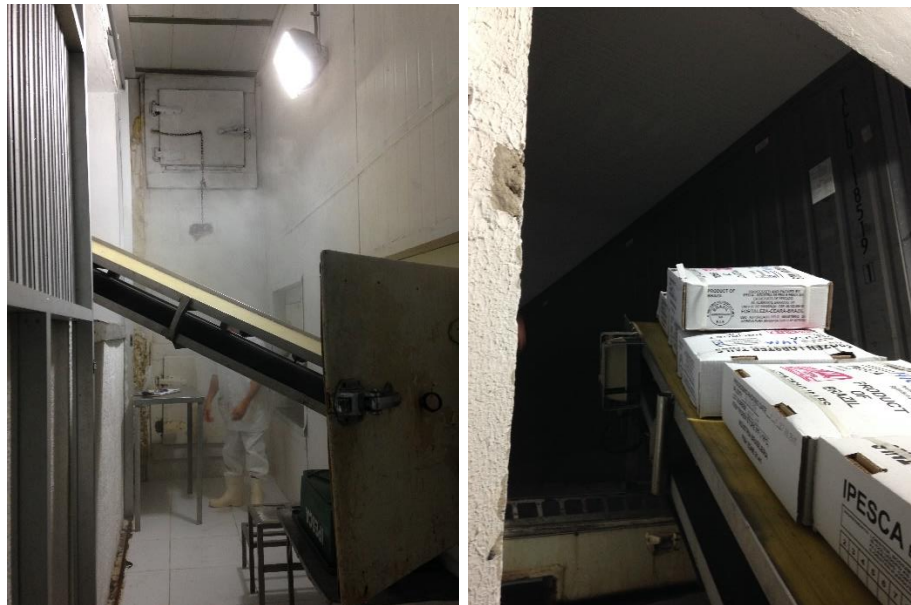
Figura 17 – Esteira interliga o óculo da câmara de estocagem ao caminhão estacionado na porta de expedição.
