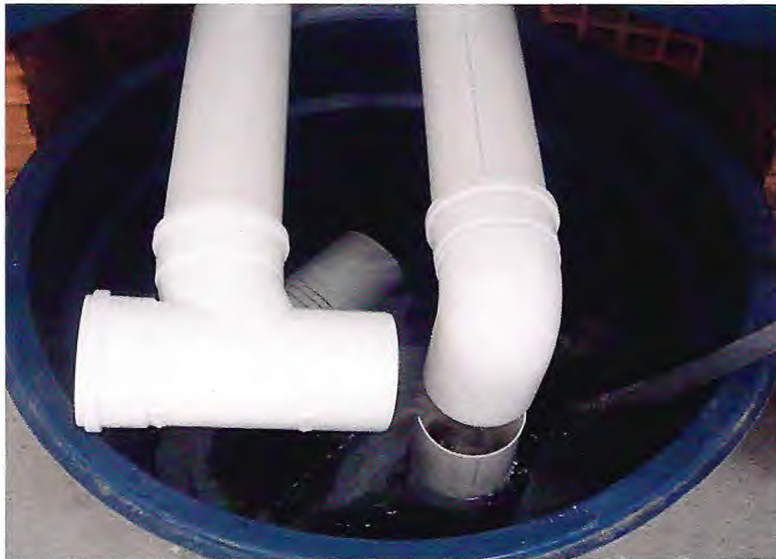
Figura 11: Detalhe do filtro utilizado no sistema de recirculação, com caixas de polietileno com capacidade de 100L.
