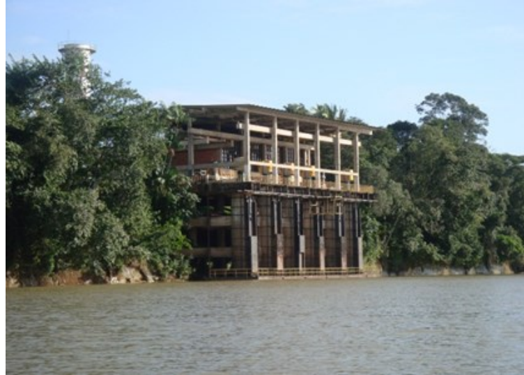
Figura 4 - Sistema de Captação de Água Italuís, localizada no Baixo Curso do Rio Itapecuru.
