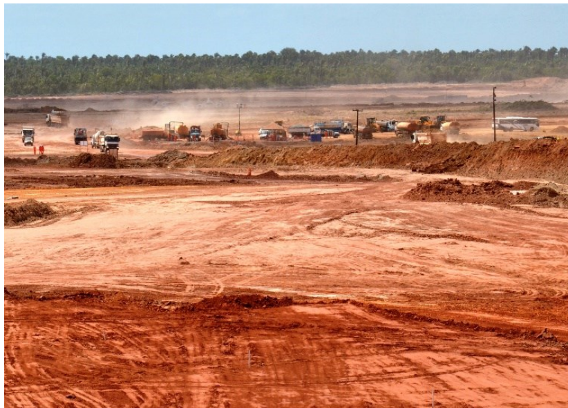
Figura 11 - Atividades de terraplenagem para implementação de empreendimento petroquímico no Município de Bacabeira.
