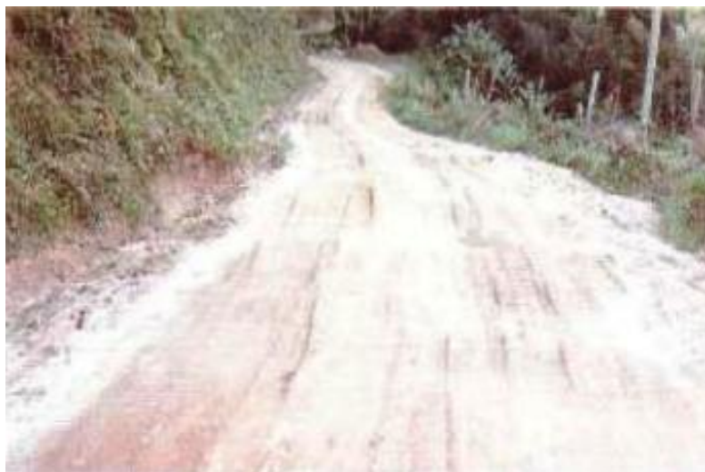
Figura 7 – Trecho com afundamento da trilha de roda
