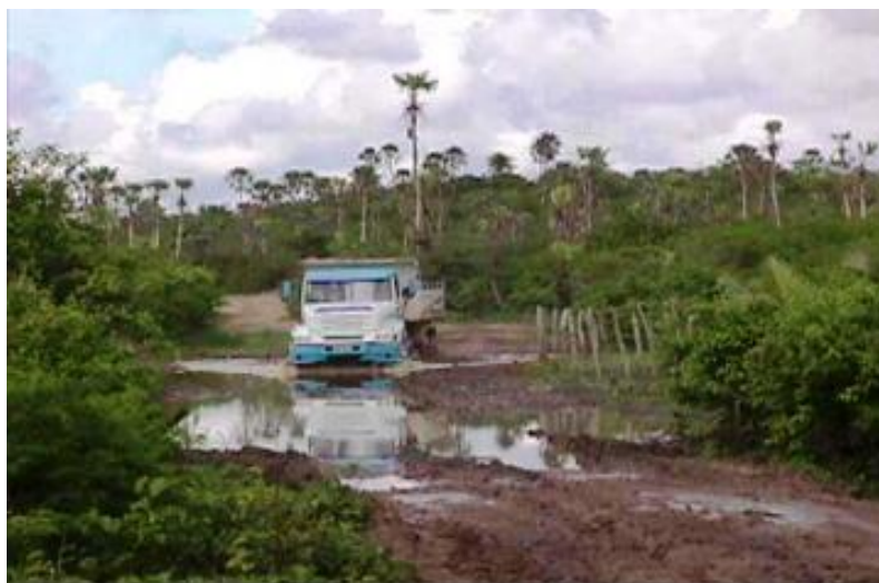
Figura 10 – Trecho da via sujeito a atoleiro
