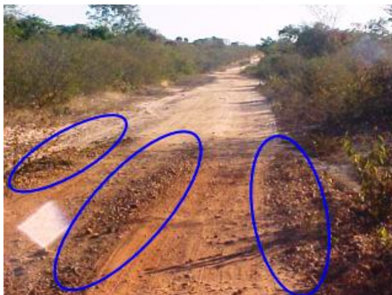
Figura 8 – Trecho expondo perda de agregados
