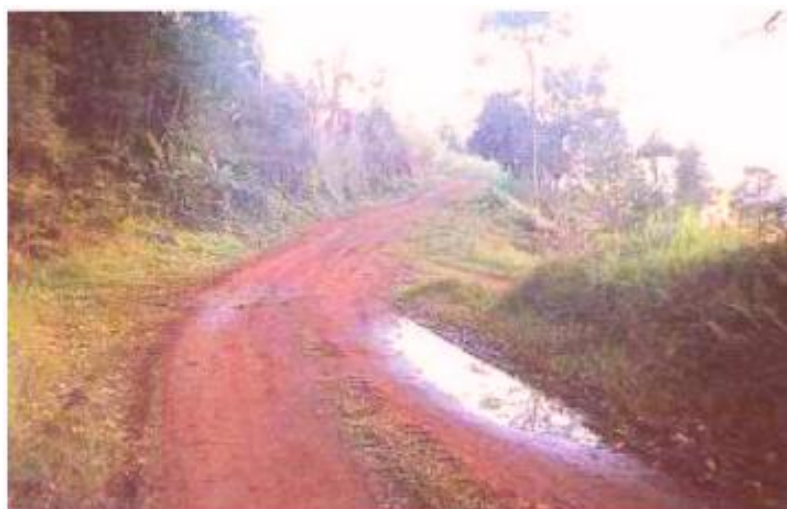
Figura 3 – Trecho com drenagem inadequada
