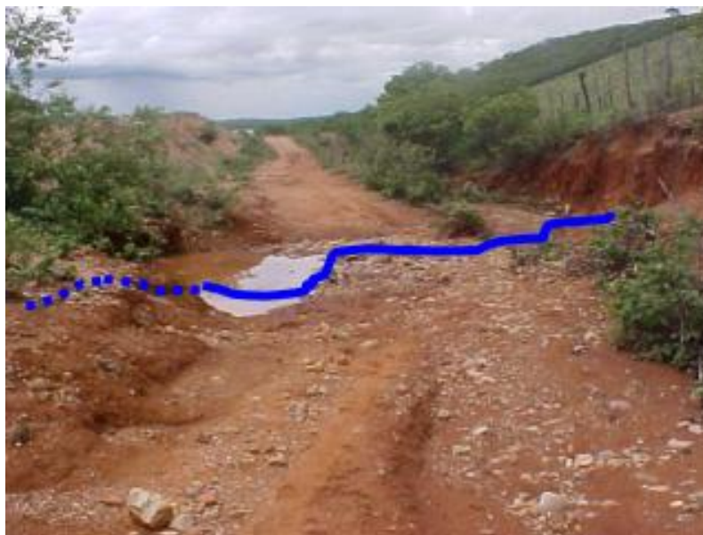
Figura 6 – Via com presença de buracos
