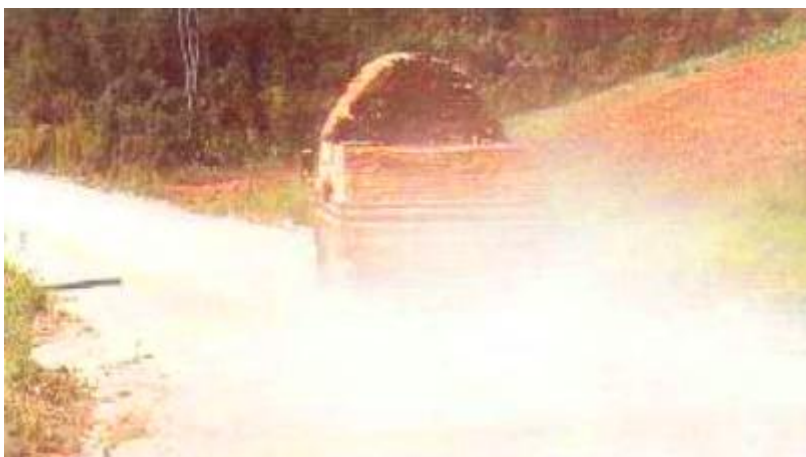
Figura 5 – Estrada com excesso de poeira
