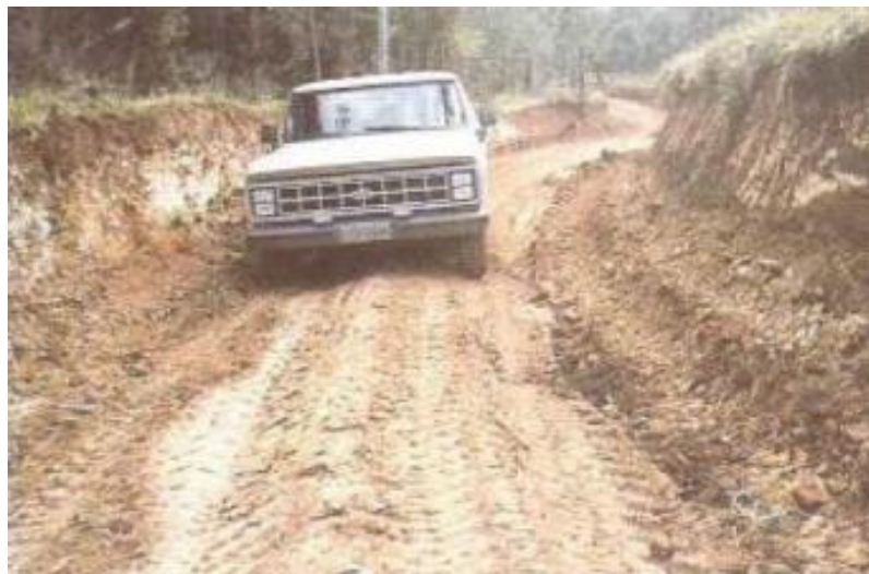
Figura 2 – Pista com seção transversal imprópria
