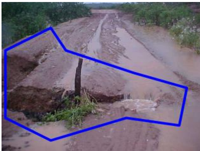
Figura 12 – Pista de rolamento rompida devido à erosão
