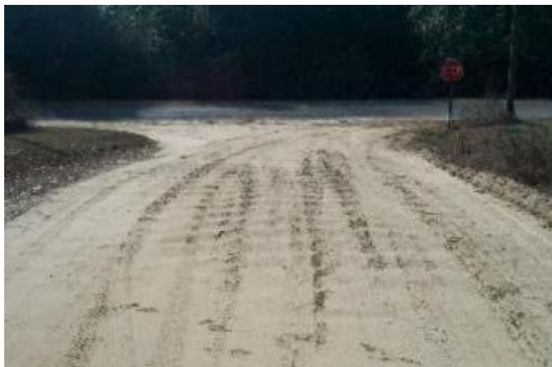
Figura 4 – Pista de rolamento com corrugações
