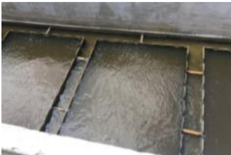
Figura 9 - Vista superior do Decantador Lamelar
