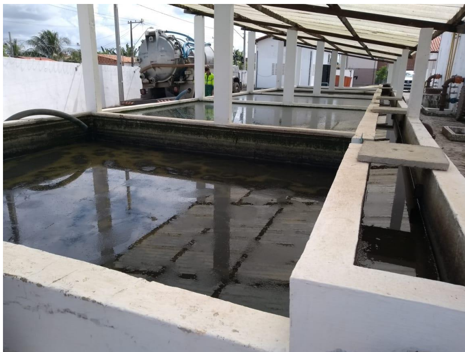
Figura 12 - Vista lateral dos Leitos de Secagem
