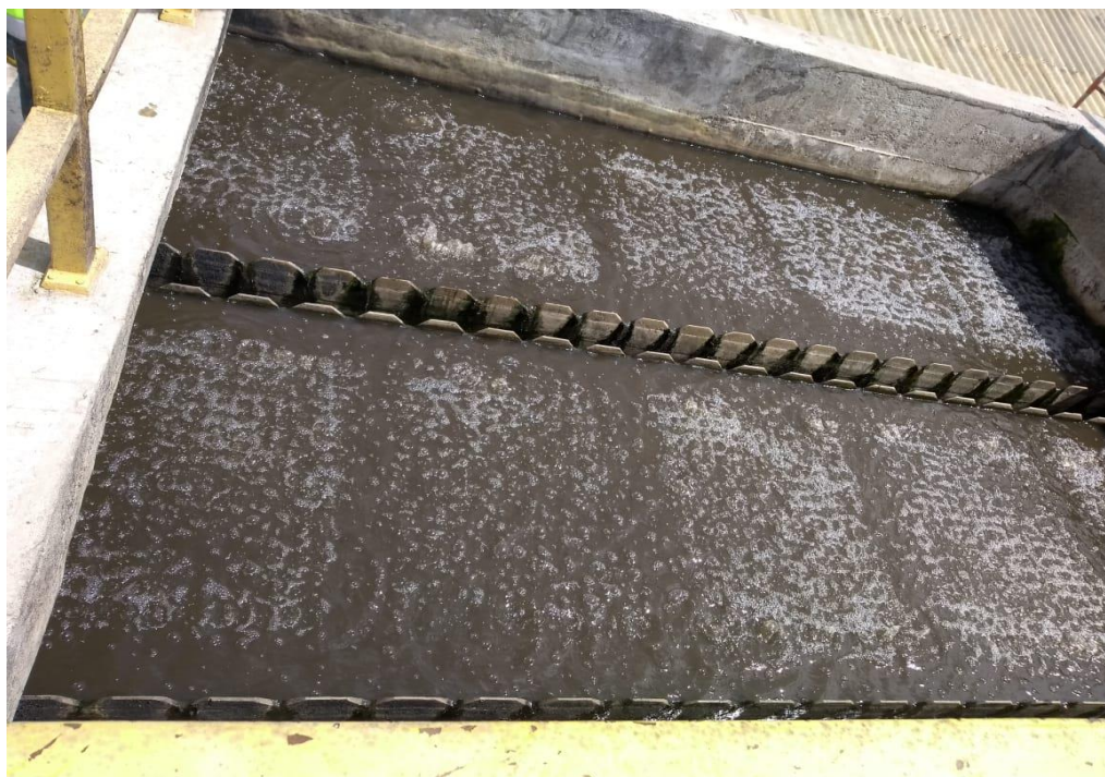
Figura 8 - Vista superior do Filtro Submerso Aerado
