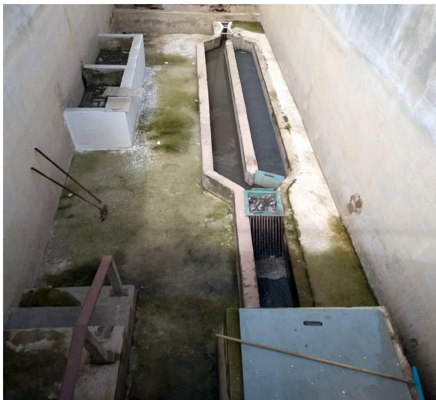
Figura 6 - Tratamento Preliminar na ETE
