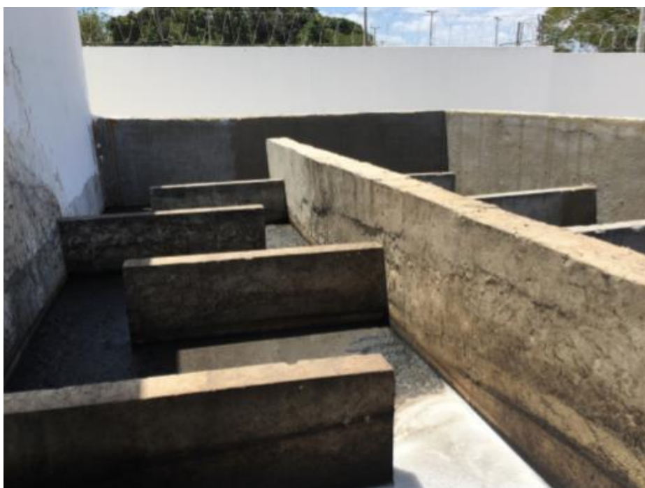
Figura 11 - Vista lateral do Tanque de Contato
