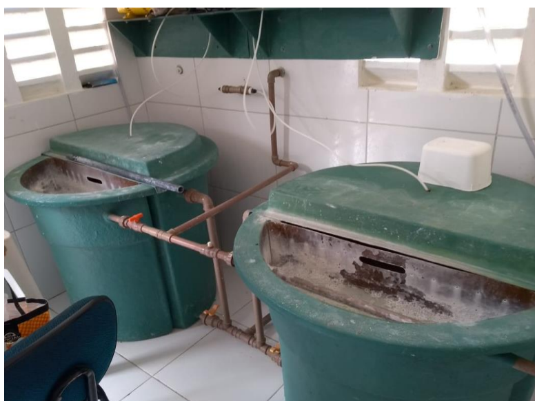
Figura 10 - Tanques de preparo de solução desinfetante
