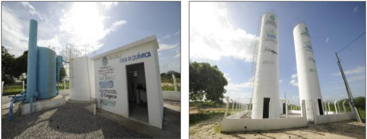
Figura 5 – Sistema de abastecimento de água Cristais – SISAR Metropolitano
