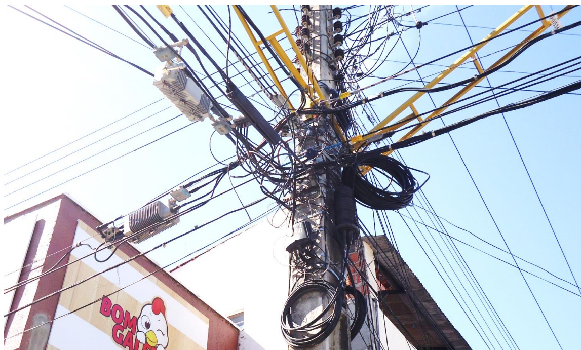
Figura 9 - Excesso de fios e cabos em poste na cidade de Fortaleza.
