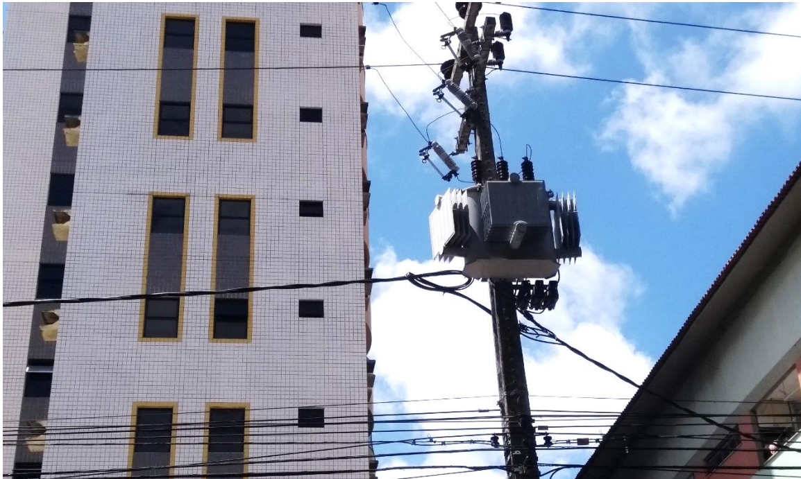
Figura 3 - Transformador de distribuição na Av. Barão de Studart em Fortaleza, Ceará.
