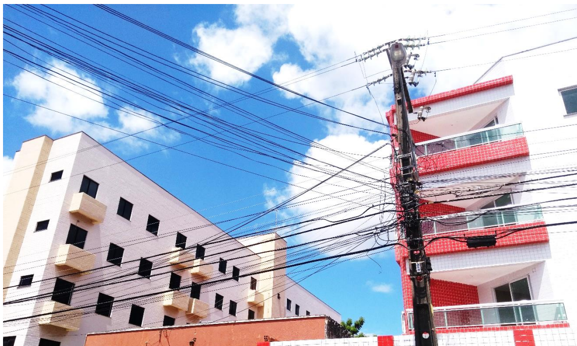
Figura 5 - Rede aérea convencional. Presença da rede primária, secundária, cabos de telecomunicação e acessório de iluminação.
