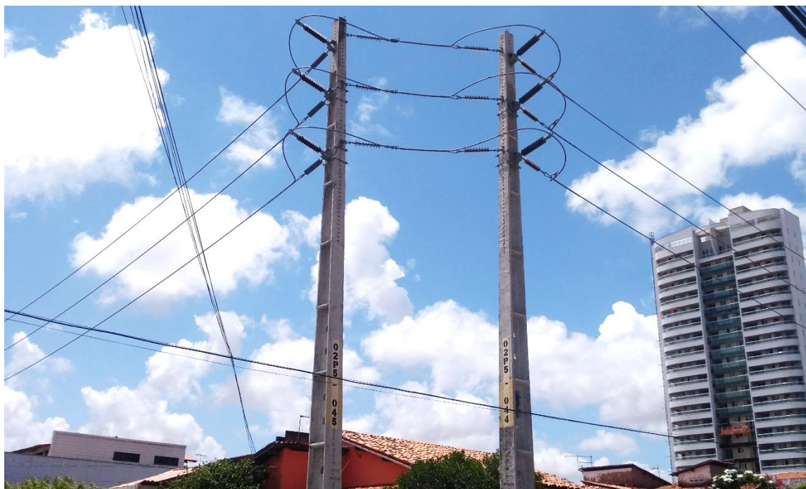
Figura 2 - Linha de distribuição de alta tensão no bairro Parquelândia em Fortaleza, Ceará.
