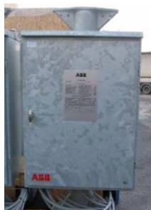
Figura 36 – Cubículo de controle local
