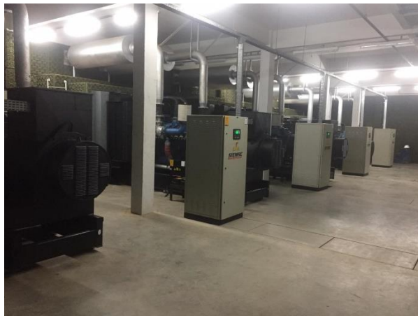
Figura 65 – Grupo Gerador e USCAs
