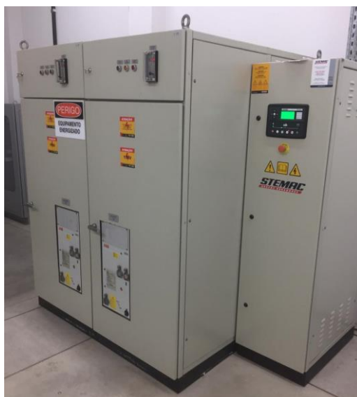
Figura 66 – Quadro de Transferência Automática (QTA)
