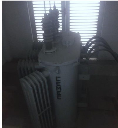
Figura 67 – Transformador de Serviços Auxiliares (TSA)
