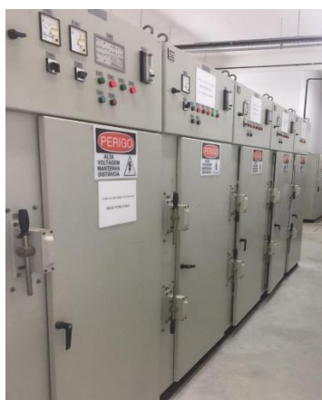
Figura 64 – Painel de Média Tensão
