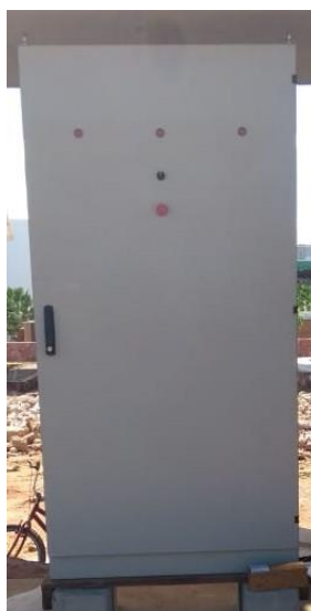
Figura 46 - Quadro elétrico de comando.
