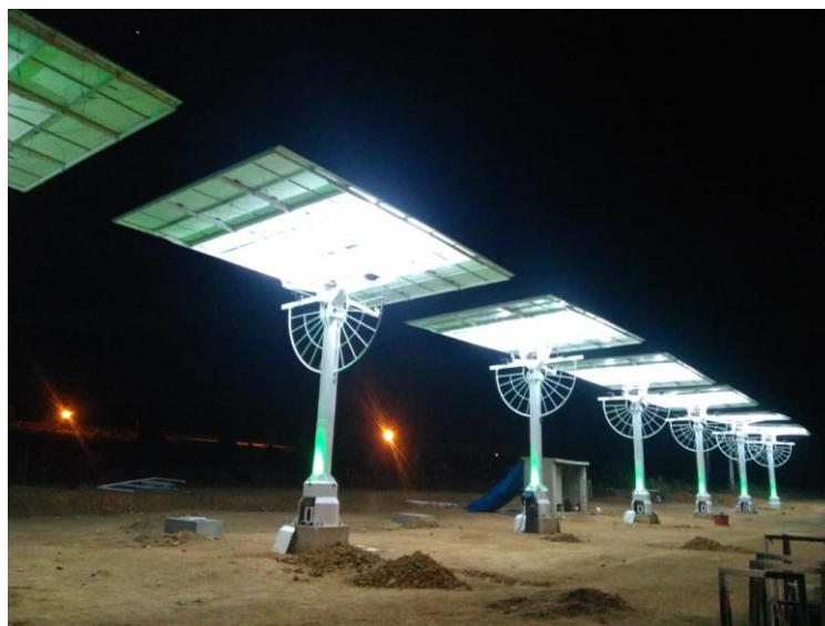
Figura 52 - Teste de iluminação dos geradores.
