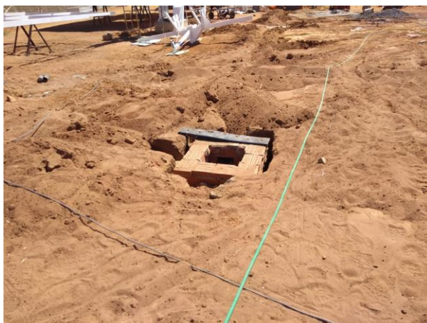
Figura 37 - Caixa de passagem em alvenaria.
