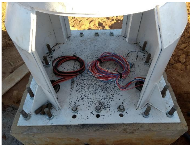
Figura 40 - Cabos na base do gerador.
