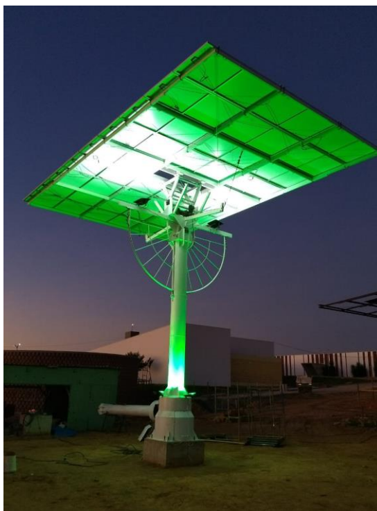
Figura 53 - Detalhe de iluminação de um gerador individual.
