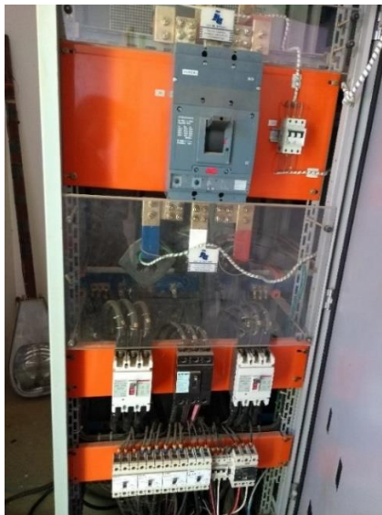
Figura 43 - Quadro geral de baixa tensão.
