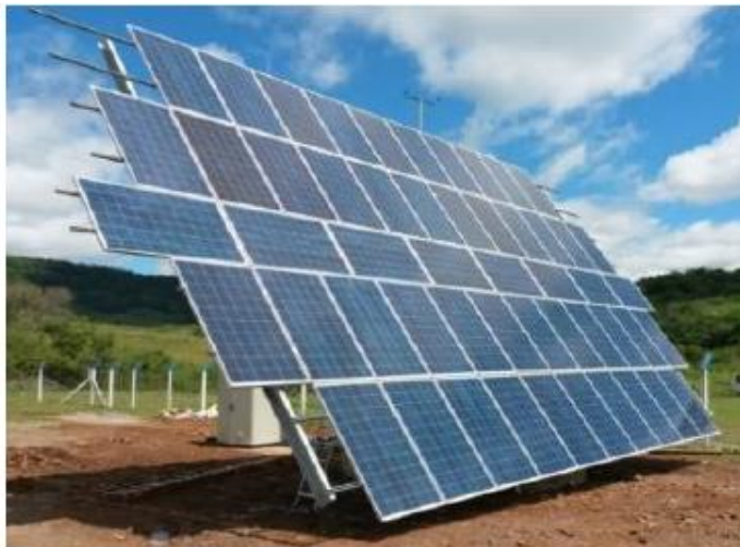
Figura 6 - Estrutura do seguidor solar em Jaguari – RS.
