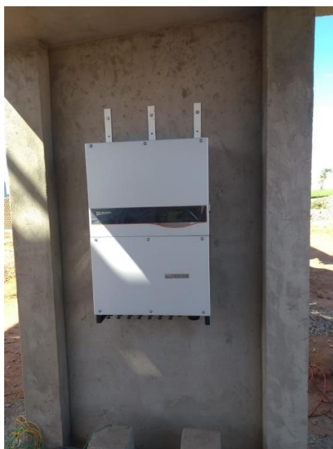
Figura 42 - Inversor solar instalado em parede do abrigo.
