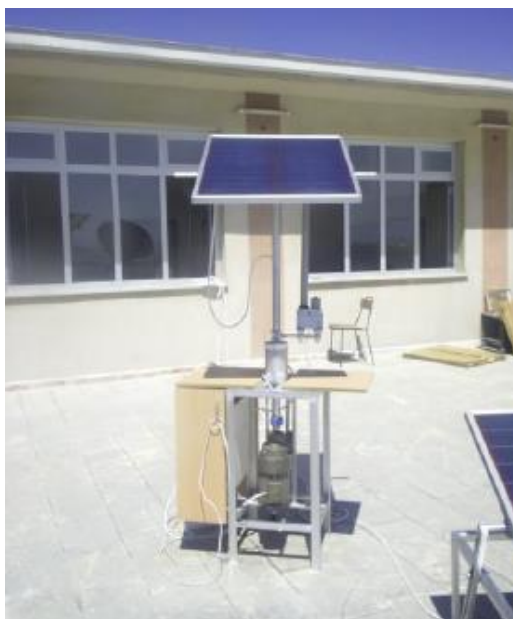
Figura 10 - Módulo FV em seguidor solar.
