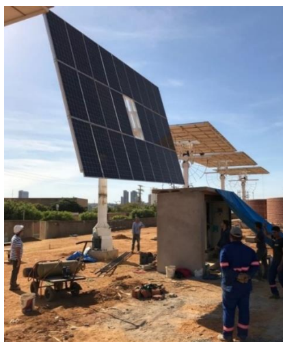
Figura 47 - Teste de Gerador Heliotrópico.
