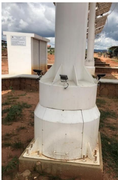
Figura 26 - Detalhe da parte mais inferior do tronco do gerador.
