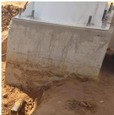
Figura 25 – Base de concreto do gerador.
