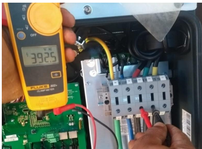
Figura 48 - Tensão de linha na saída do inversor solar.
