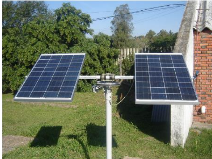
Figura 2 – Seguidor solar com módulos instalados.
