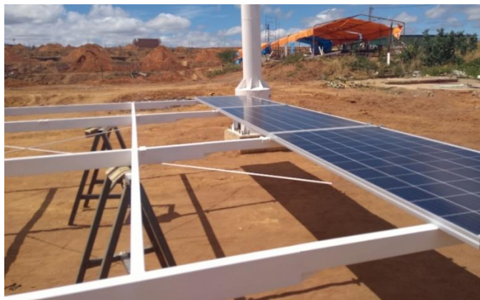
Figura 41 - Fixação de módulos FV em grade.
