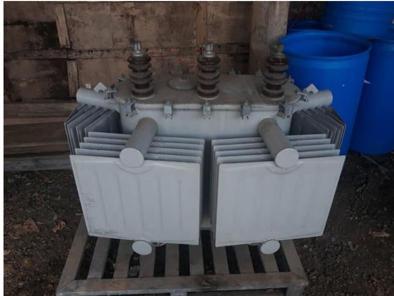
Figura 1, Transformador de 500 kVA.
