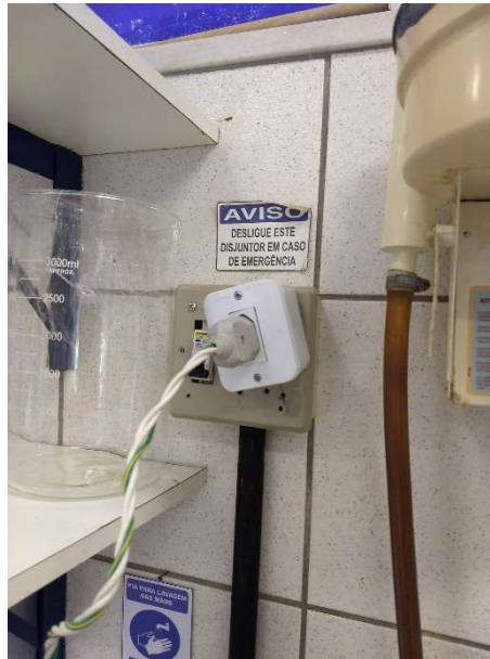
Figura B05 - Registro Fotográfico na Sala de Aparelhagem 4
