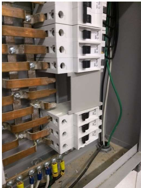
Figura B02 - Registro Fotográfico na Sala de Aparelhagem
