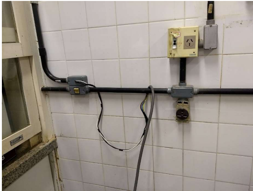
Figura B07 - Registro Fotográfico na Sala de Aparelhagem 3
