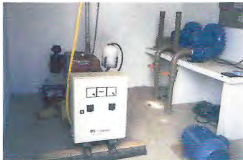
Figura 34 - Vista da casa de máquinas dos tanques berçários, observando-se a direita dois sopradores de ar e a esquerda um gerador de emergência, para acionamento dos referidos aeradores.
