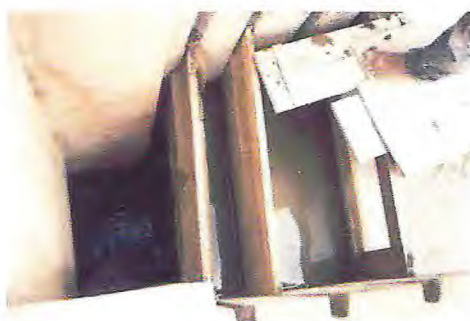
Figura 25 - Visão de cima do sistema de drenagem, com comportas dispostas no sentido de drenagem da água de fundo.
