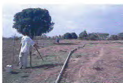
Figura 3 – Altimetria do terreno, com colocação de piquetes indicativos para os trabalhos de construção com máquinas.
