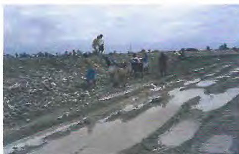
Figura 5 - Detalhe da colocação de pedras para a proteção dos taludes de montante do viveiro
