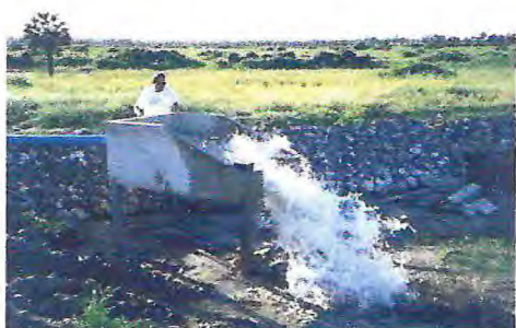
Figura 16 – Sistema de abastecimento em funcionamento. Observe no detalhe que a estrutura inicial foi modificada.
