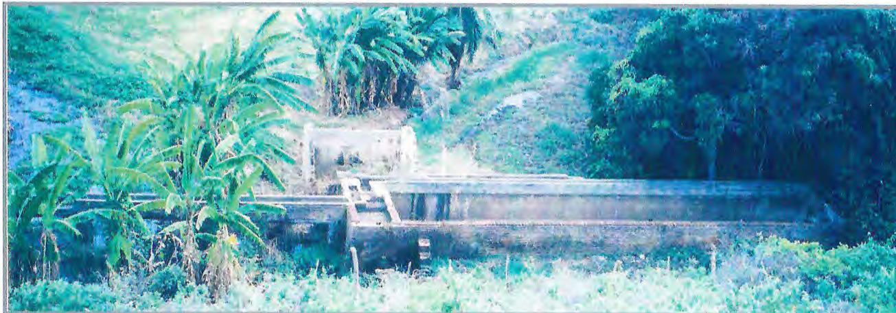
FIGURA 13 - Vista parcial da galeria com o canal de irrigação desativado a jusante do açude Marengo em 24/02/05.
