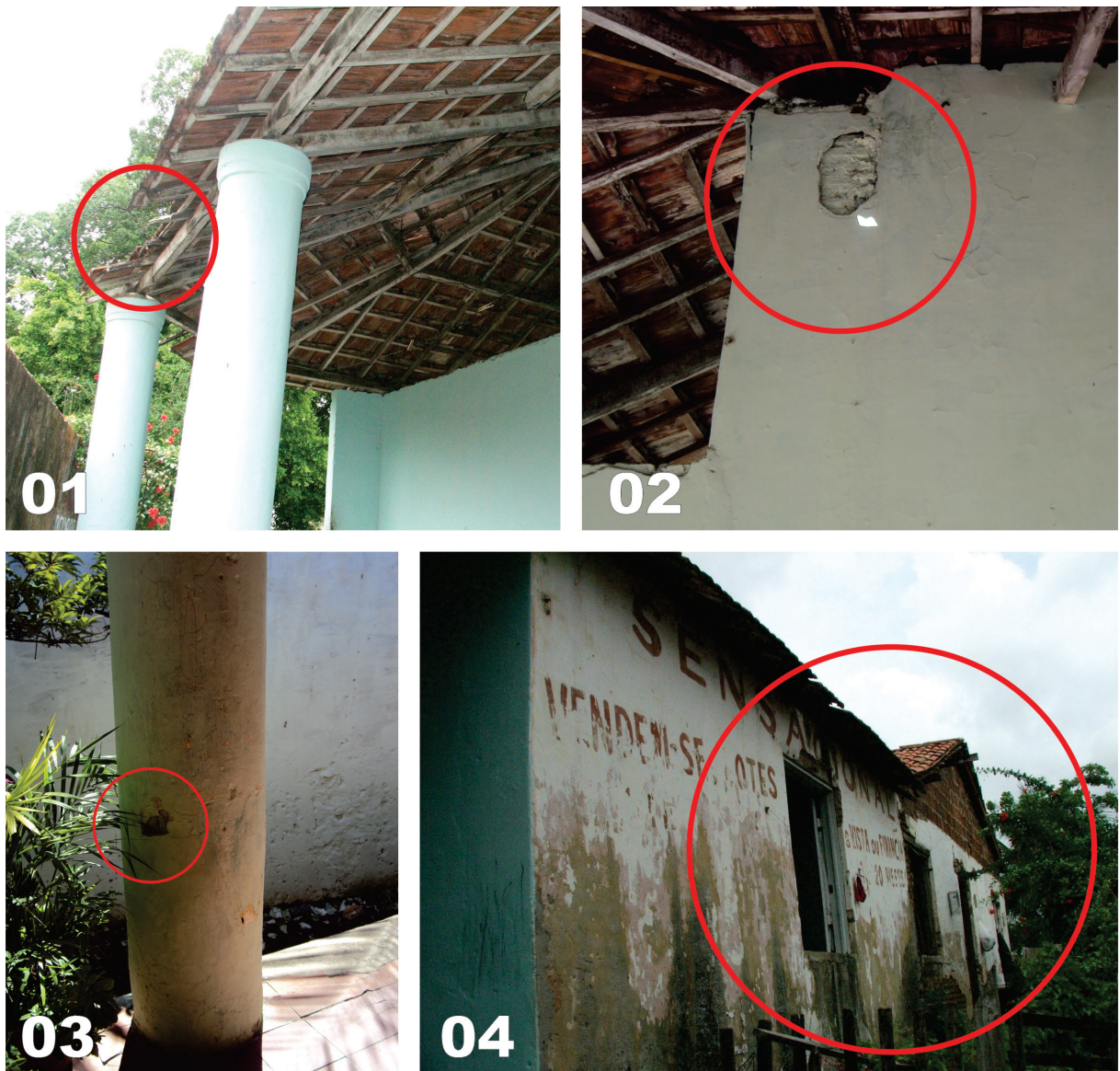
Figura 29: Danos Fachada Nordeste. Fonte: Elaborado pela autora.
