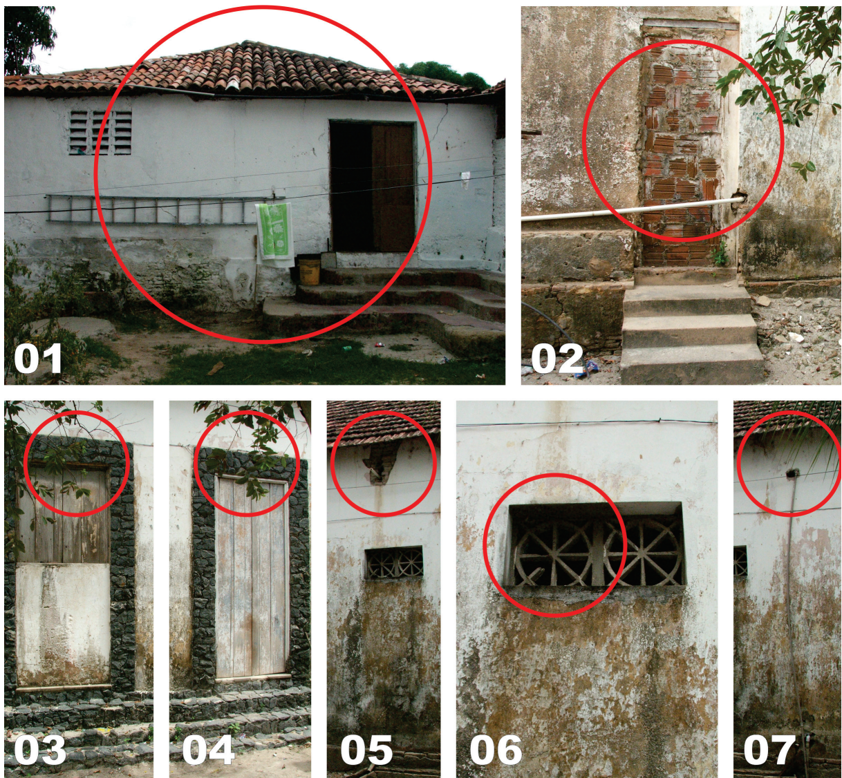
Figura 33: Danos Fachada Sudoeste. Fonte: Elaborado pela autora.
