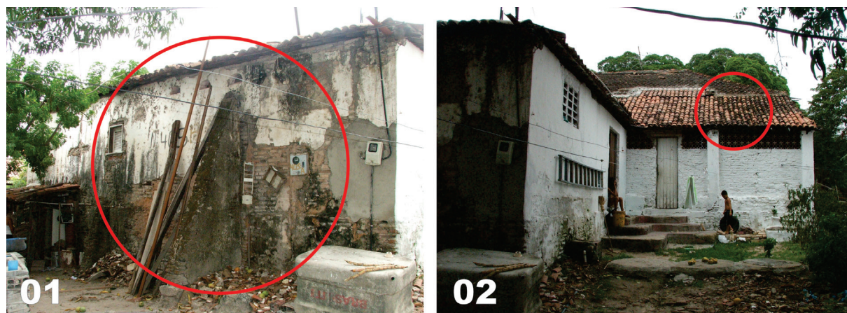
Figura 31: Danos Fachada Noroeste. Fonte: Elaborado pela autora.
