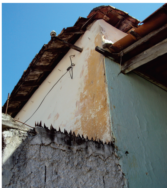
Figura 34: Presença de tons amarelados na fachada. Fonte: Elaborado pela autora.
