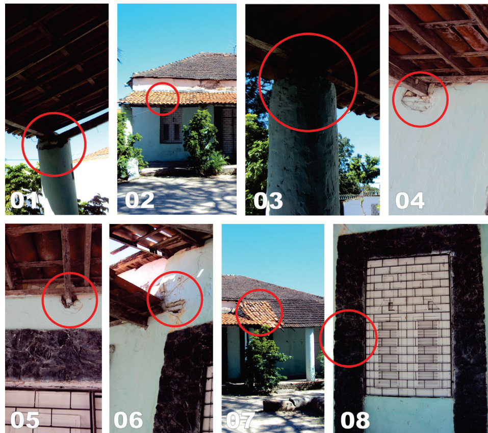
Figura 26: Danos Fachada Sudeste. Fonte: Elaborado pela autora.
