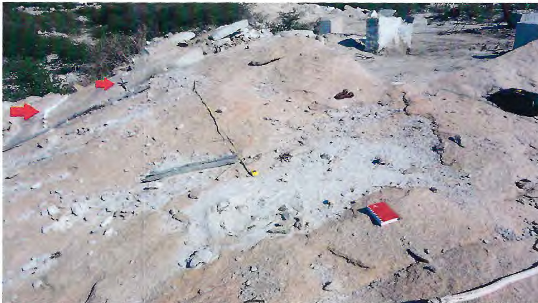
Foto 6.5: Execução de furos usando marleteles e cunhas metálicas (canto superior esquerdo) posicionadas em paralelo para posterior desmonte de rocha.
