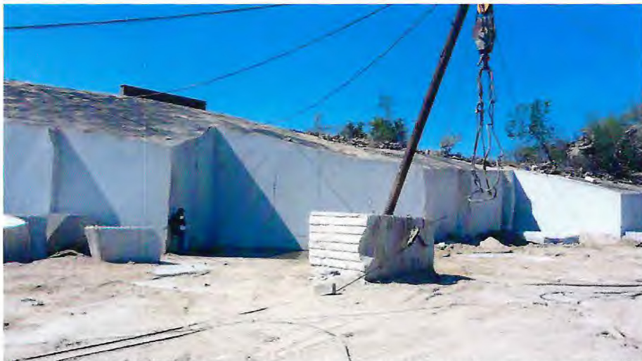
Foto 6.3: Frente de lavra F2, que encontra-se desativada, onde não foi usada a técnica de desmonte em bancadas baixas, e foram observadas diáclases subhorizontais geradas por alívio de pressão.
