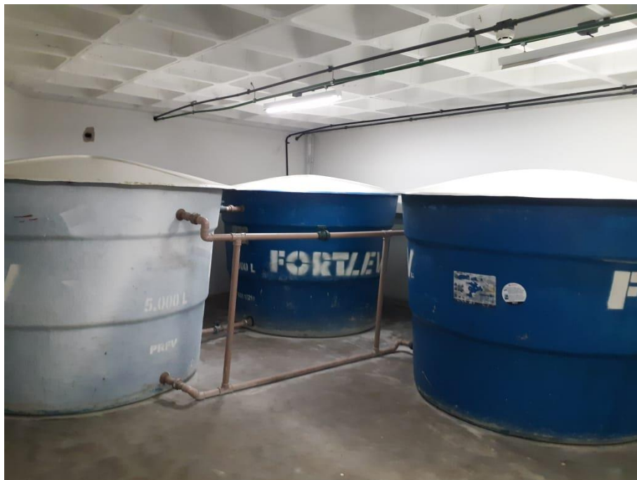
Figura 22 - Tanques de reuso.
