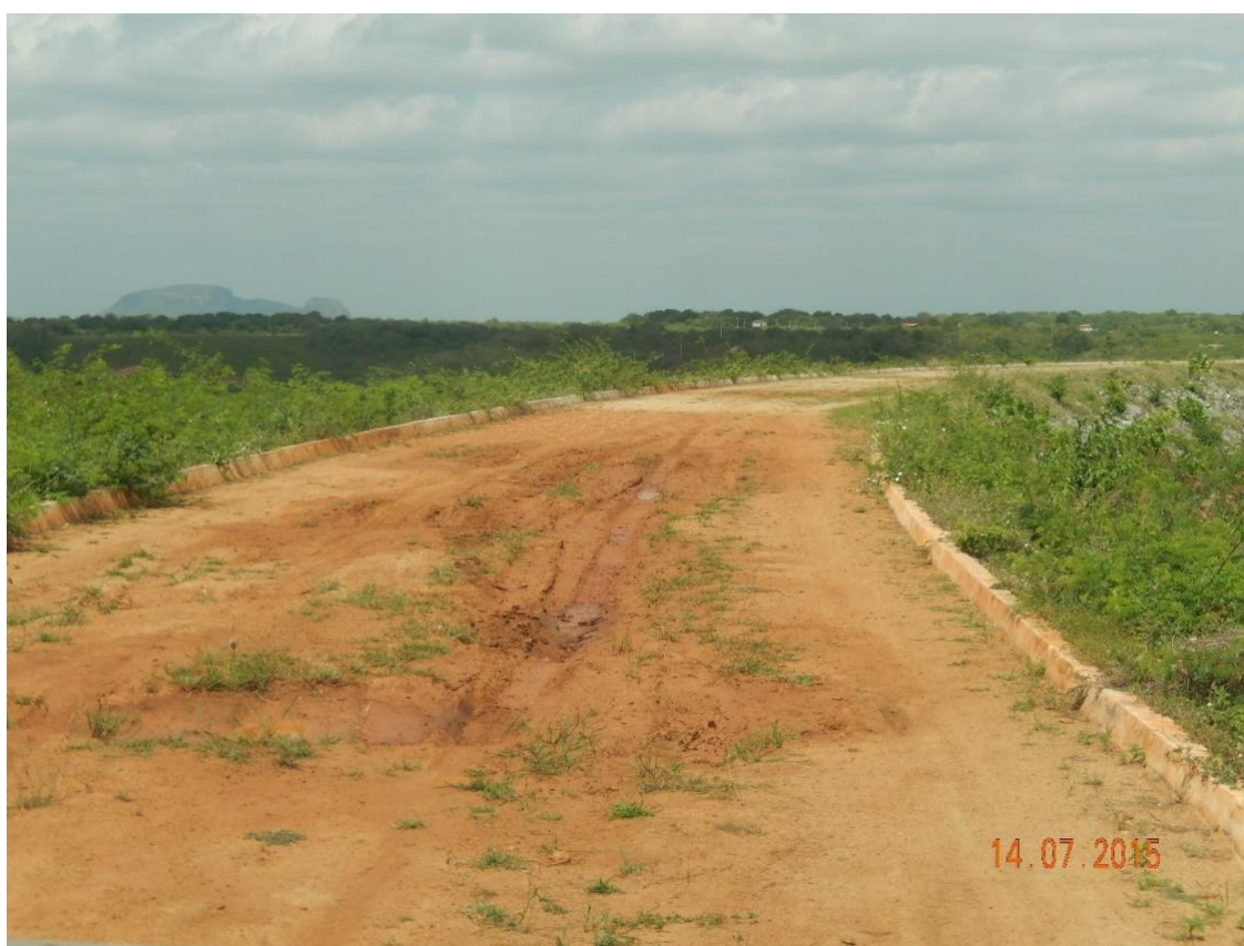
Figura 9 - Registro de afundamento no coroamento em Aracoiaba, 2015 (Fonte: COGERH, 2015)
