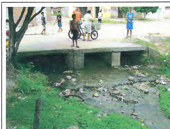
Figura 8 - Passagem de água por baixo da Rua Suíça. Lado sul da lagoa da Maraponga.
