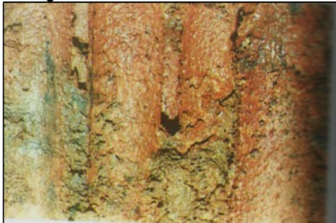
Figura 9 - Trecho de feixe de tubos com fouling bacteriano
