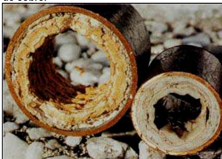
Figura 2 - Incrustações de carbonato de cálcio formadas em um condensador (à esquerda) e em um trocador de calor (à direita) com tubos de cobre.
