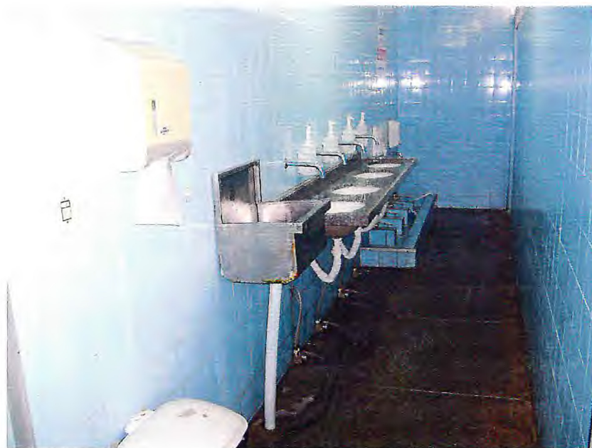
Figura 25 - Gabinete de higienização na Indústria INTERFRIOS – Intercâmbio de Frios S.A., em Fortaleza, Ceará.
