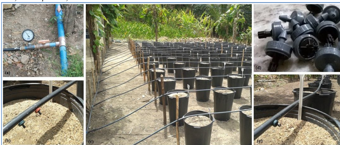
Figura 4 - Linha de derivação saindo da linha principal (a), gotejadores combinados (b), linha de derivação com as linhas laterais (c), gotejadores de botão, (d) e gotejador individual (e). FEP, Redenção CE, 2014/2015.
