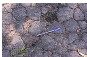
Trincas em forma de “couro de jacaré”
