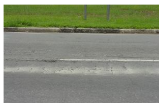
Bombeamento de finos
