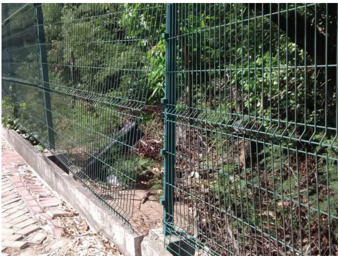
Figura 04 Cerca metálica avariada - Área verde do entorno do Rio Cocó - Fortaleza
