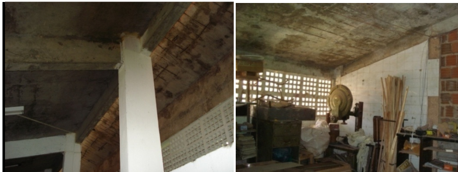
Fig.19–IPPOO – 2009 - Rachaduras, exposição e oxidação da estrutura (à esquerda). Laje com fontes de infiltração (à direita).
