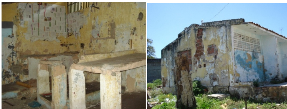
Fig.20–IPPOO – 2009 - Rachaduras, exposição e oxidação da estrutura (à esquerda). Laje com fontes de infiltração (à direita).
