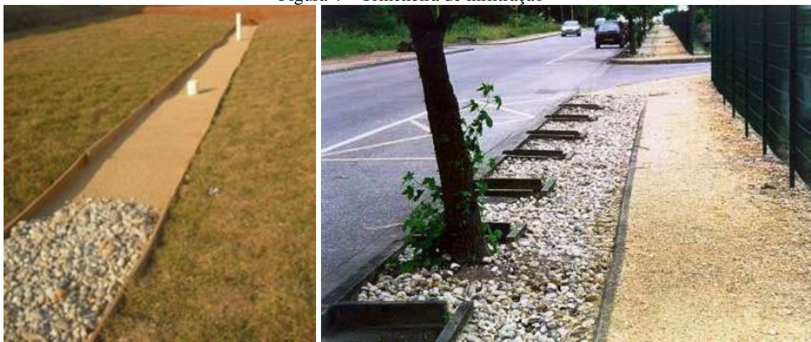
Figura 4 – Trincheira de infiltração
