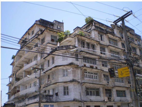
Figura 41 - Esquadrias fechadas com alvenaria e vegetação subindo pela edificação
