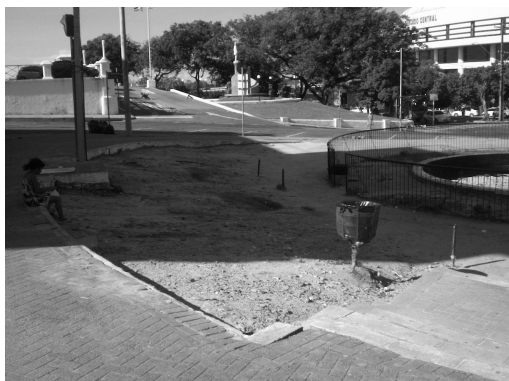
FIGURA 23 – Área com com piso totalmente danificado
