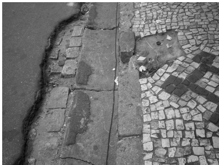
FIGURA 51 – Calçada e sarjeta em péssimas condições
