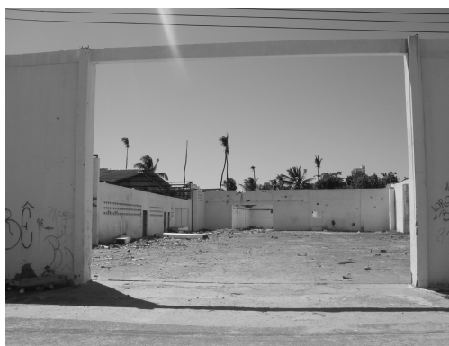
FIGURA 50 – Galpão degradado nas cercanias do Poço da Draga
