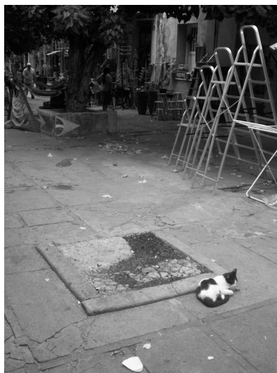
Figura 54 – Piso em péssimo estado e produtos expostos no meio da rua Crato
