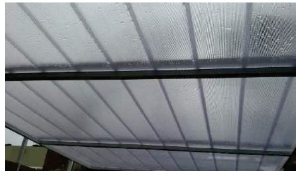
Img 30. Cobertura em policarbonato alveolar Translúcido.
