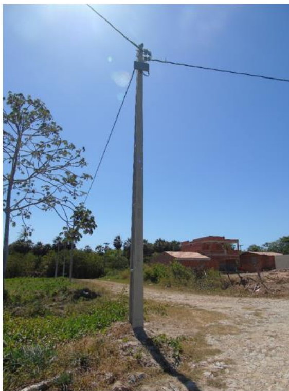
Figura 9 – Rede de distribuição aérea isolada de baixa tensão.
