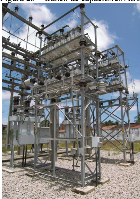
Figura 25 – Banco de capacitores ABB.
