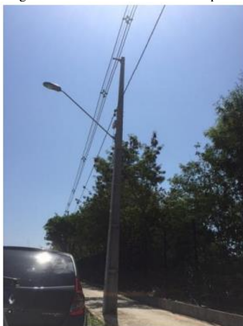
Figura 8 – Rede convencional compacta.
