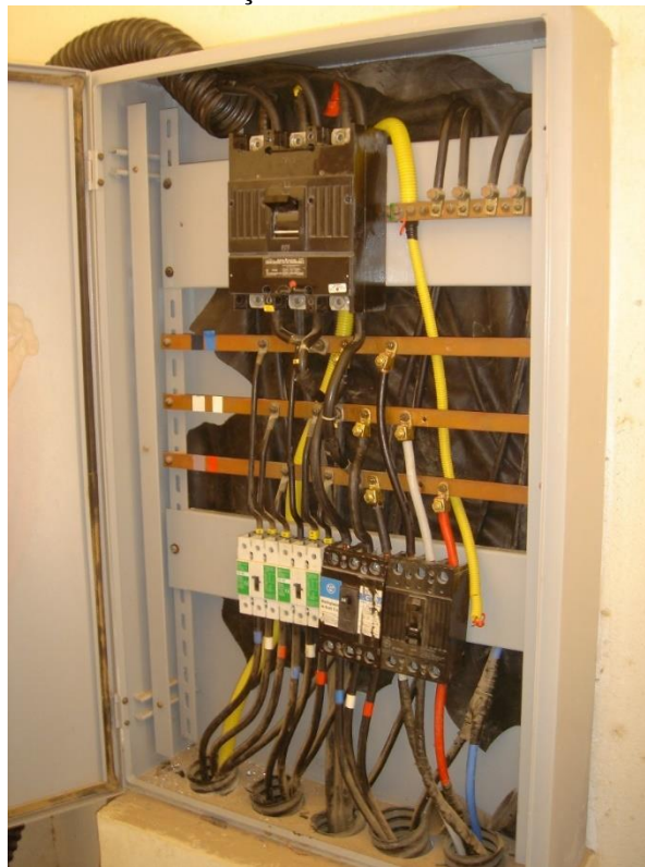
Figura 38 – Quadro geral de força em uma das subestações de Jericoacoara.
