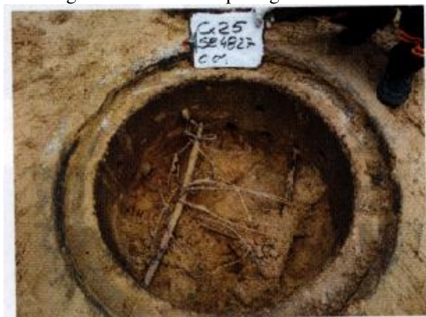
Figura 55 – Caixa de passagem soterrada.
