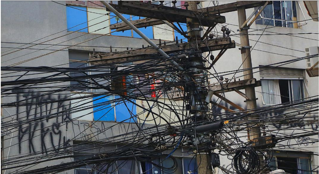
Figura 2 – Poluição visual gerada por condutores elétricos.
