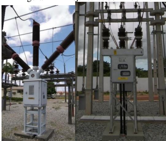
Figura 22 – Disjuntores de AT e MT.
