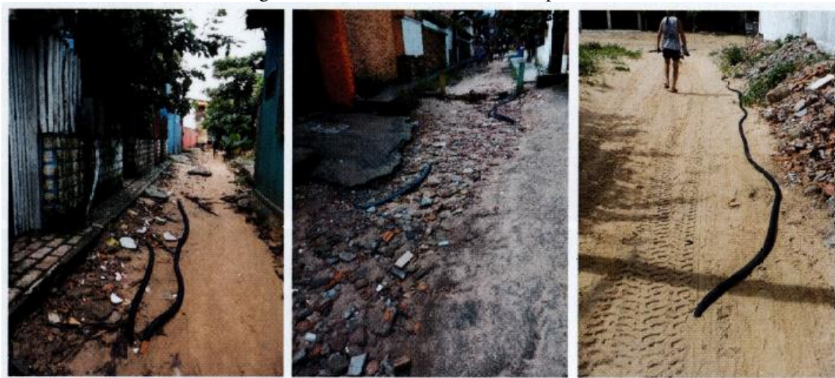
Figura 59 – Dutos de baixa tensão expostos.
