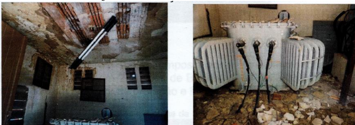
Figura 54 – Estrutura com risco de desabamento.
