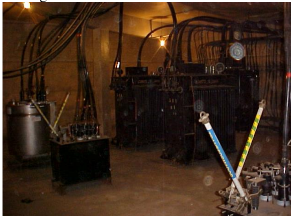
Figura 31 – Câmera subterrânea CEMIG.
