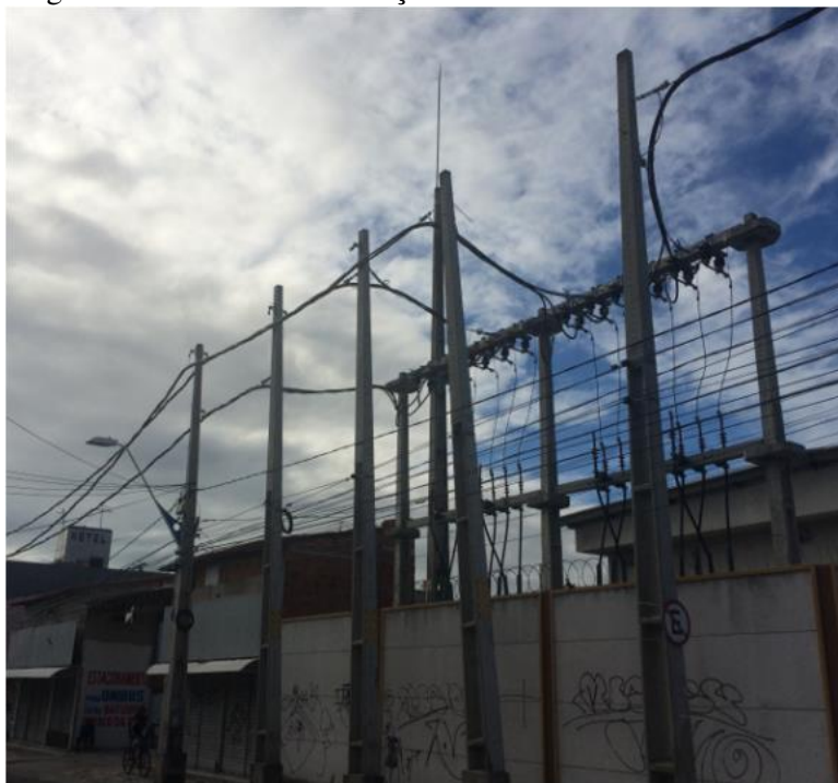
Figura 10 – Rede de distribuição aérea isolada de média tensão.
