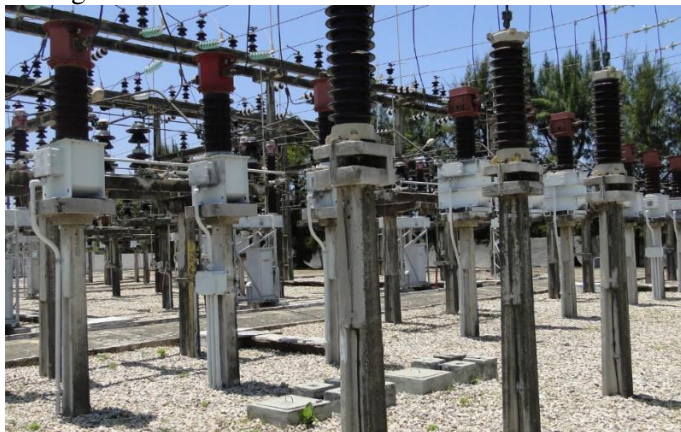
Figura 20 – Transformador de corrente ARTECHE.
