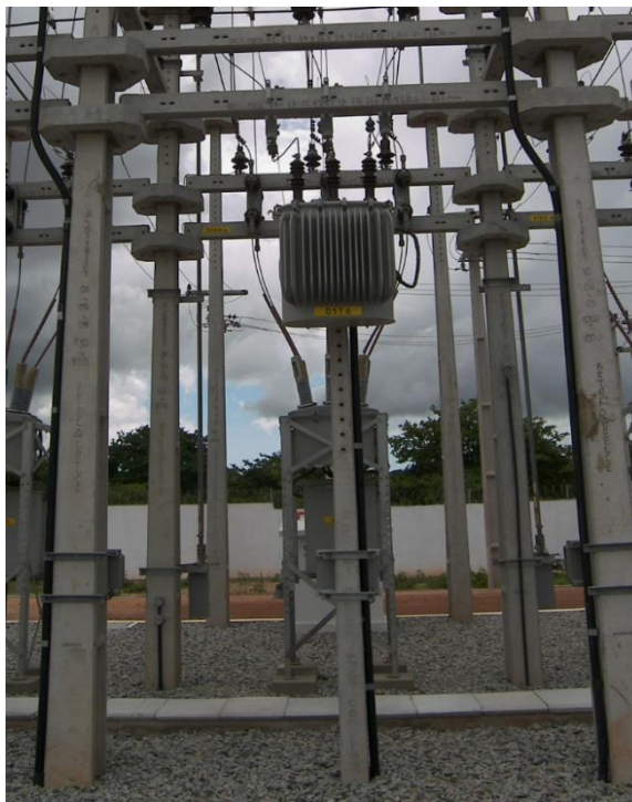
Figura 27 – Transformador de serviços auxiliares ITB.
