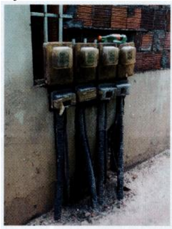
Figura 57 – Conexão dos dutos com medidores.
