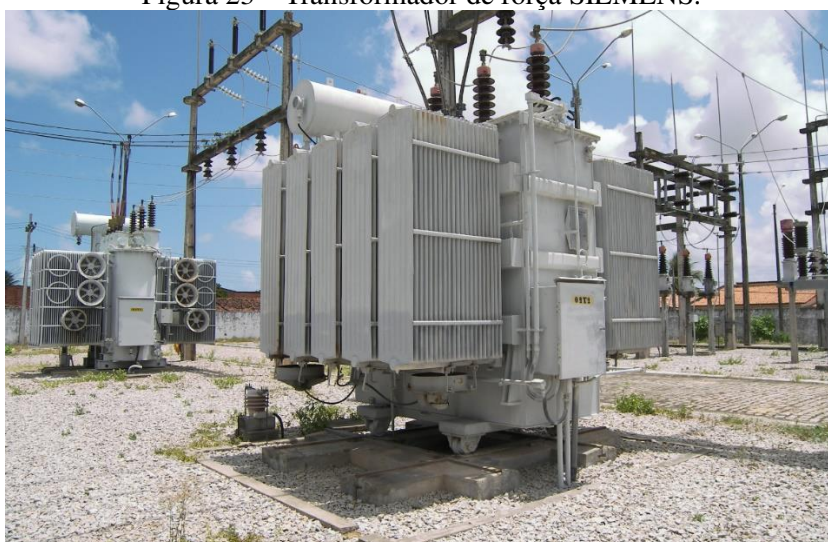
Figura 23 – Transformador de força SIEMENS.
