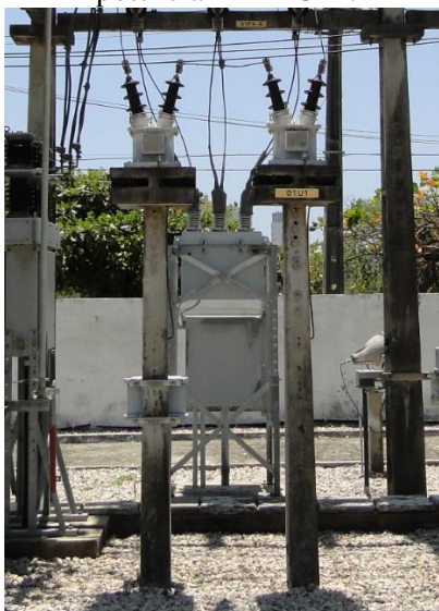
Figura 21 – Transformador de potencial HITACHI.
