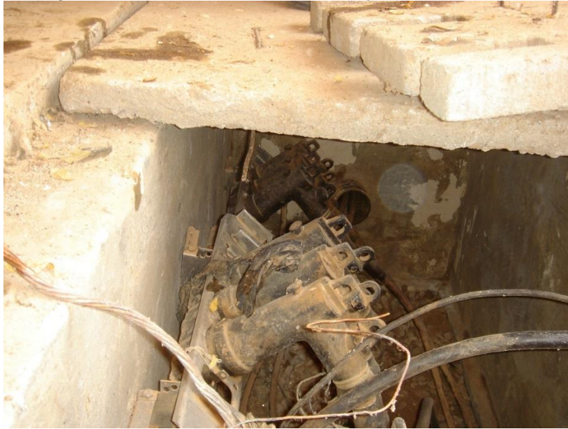
Figura 37 – Desconectáveis das subestações de Jericoacoara.
