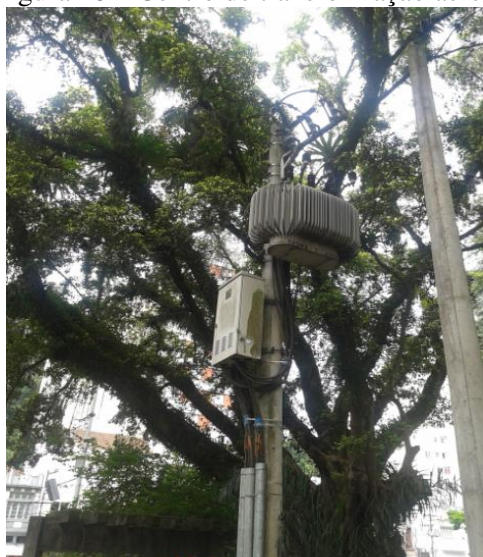
Figura 28 – Centro de transformação aéreo.
