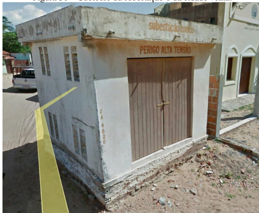
Figura 36 – Cubículo da subestação 1 da cidade velha.
