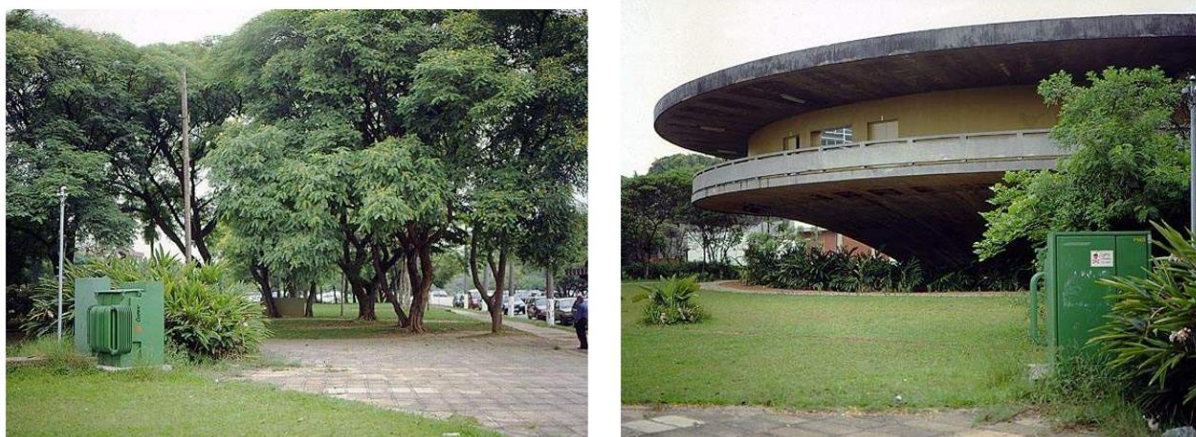
Figura 84 – Centro de transformação pad-mounted no ambiente.
