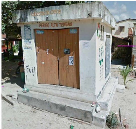
Figura 30 – Transformador em cubículo.
