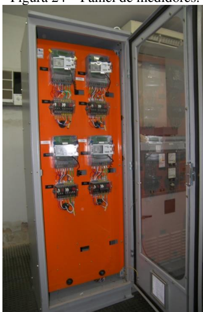
Figura 24 – Painel de medidores.
