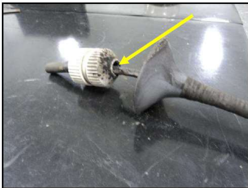
Figura 26 - Terminal mufla danificado
