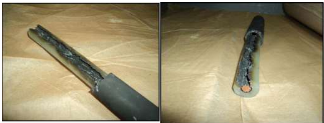
Figura 28 - Deteriorização do isolamento
