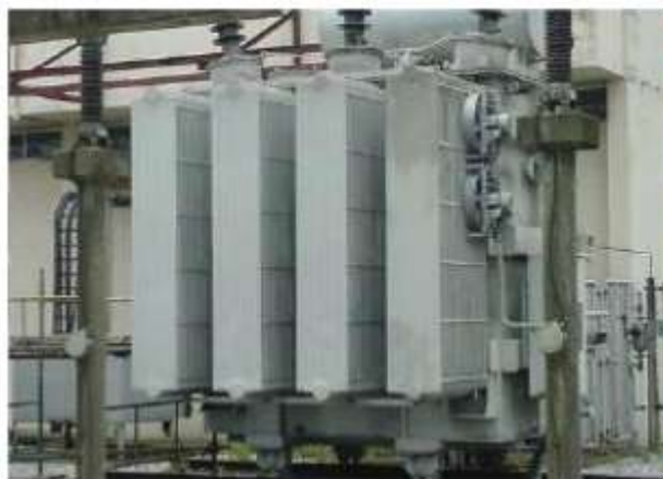
Figura 30 - Transformador da Unidade de Coque de Petróleo 2 – UCP2
