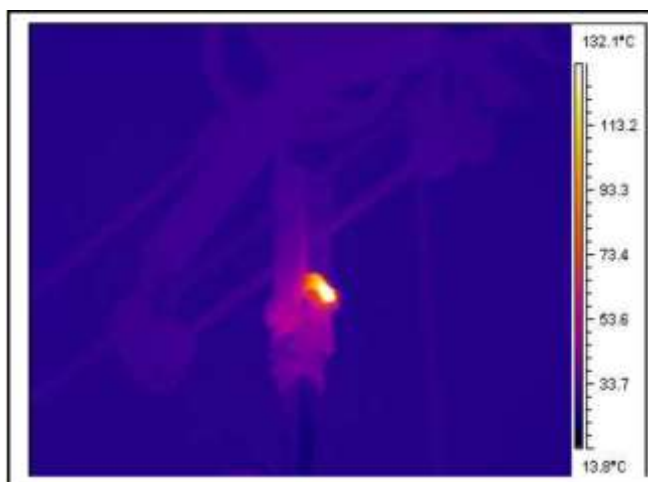
Figura 36 - Ponto quente em chave seccionadora
