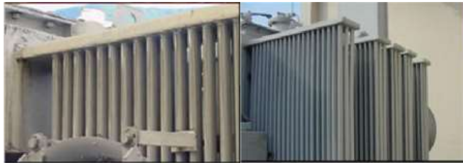
Figura 33 – Transformadores 4,16 kV/480 V
