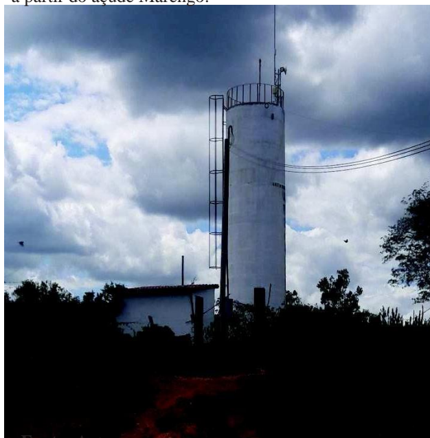
Figura 16: Caixa d'água de distribuição a partir do açude Marengo.
