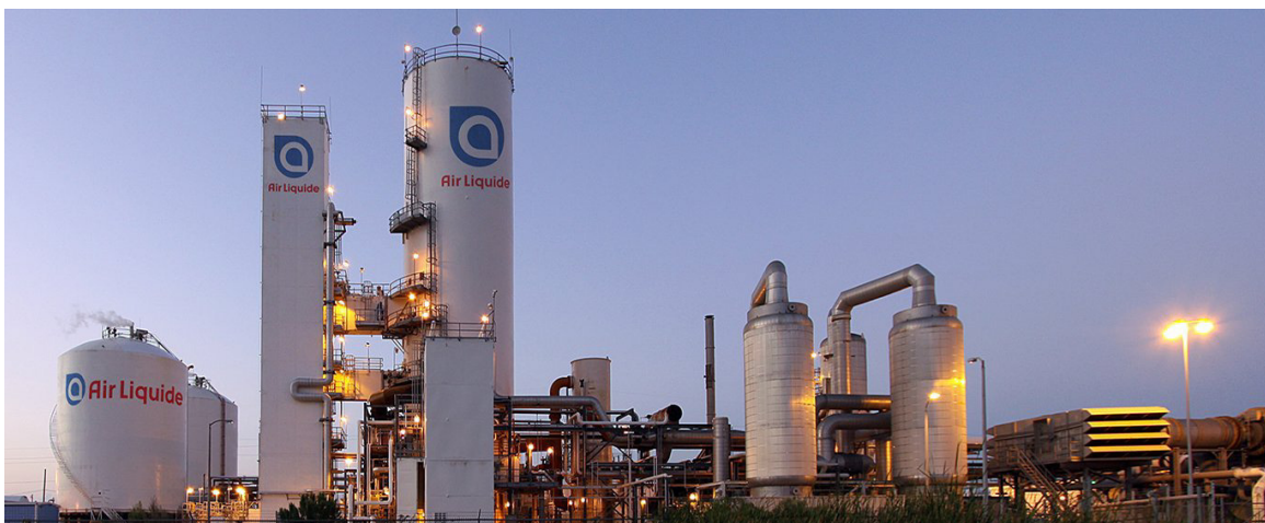
Figura 08-Planta de destilação criogênica, fornecimento on- site
