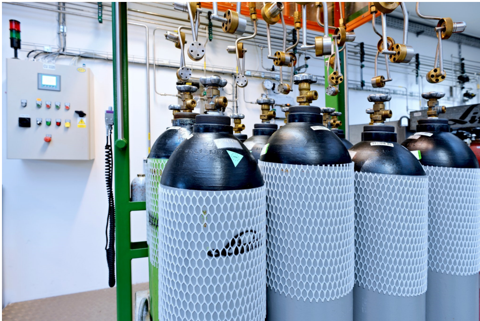
Figura 10 - Estação de enchimento de gases, modal Packaged
