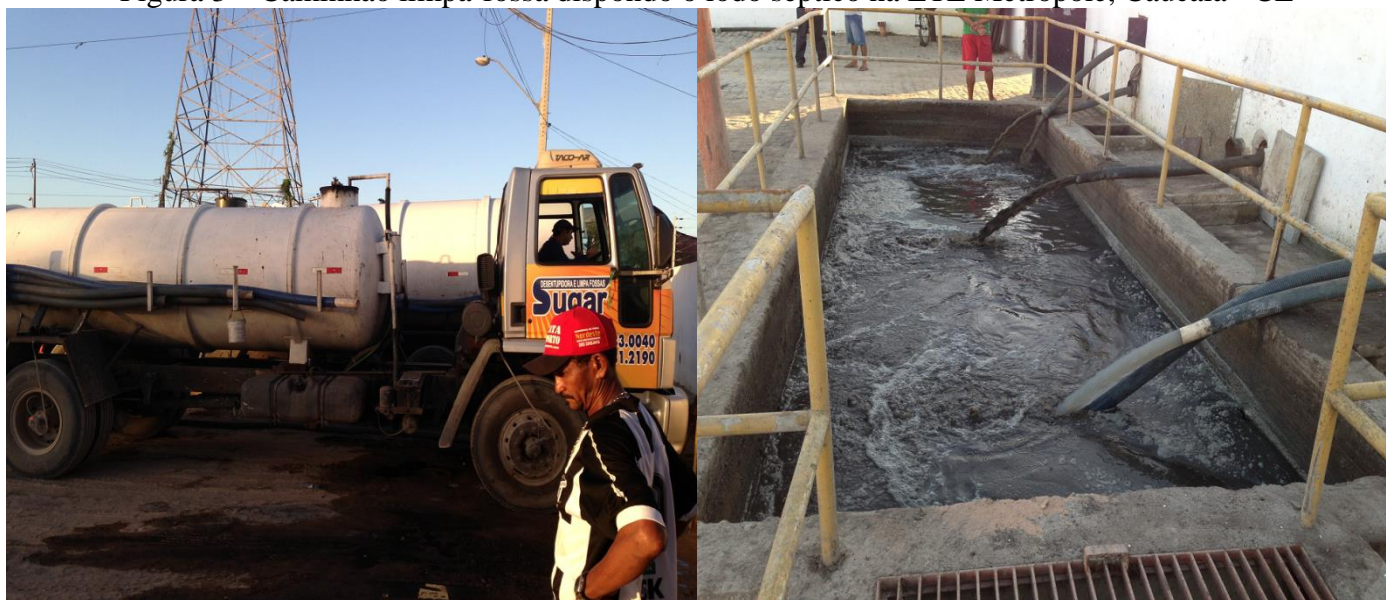
Figura 3 – Caminh o limpa-fossa dispondo o lodo s ptico na ETE Metr pole, Caucaia - CE
