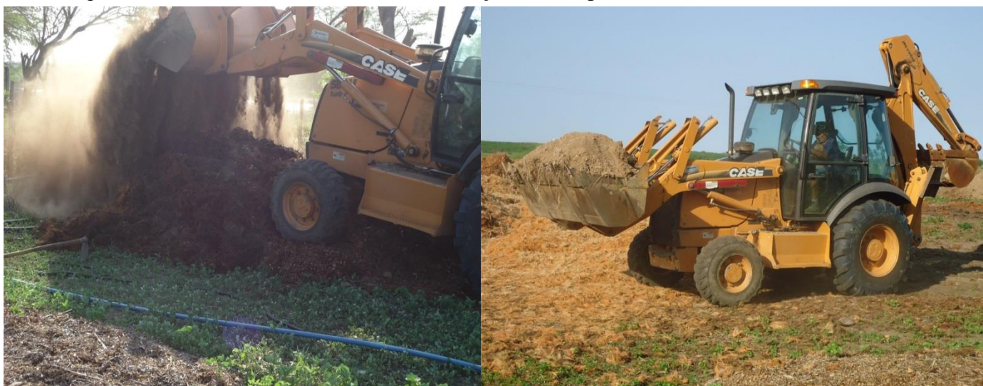
Figura 8 – Funcionamento do sistema de aeração natural por trator
