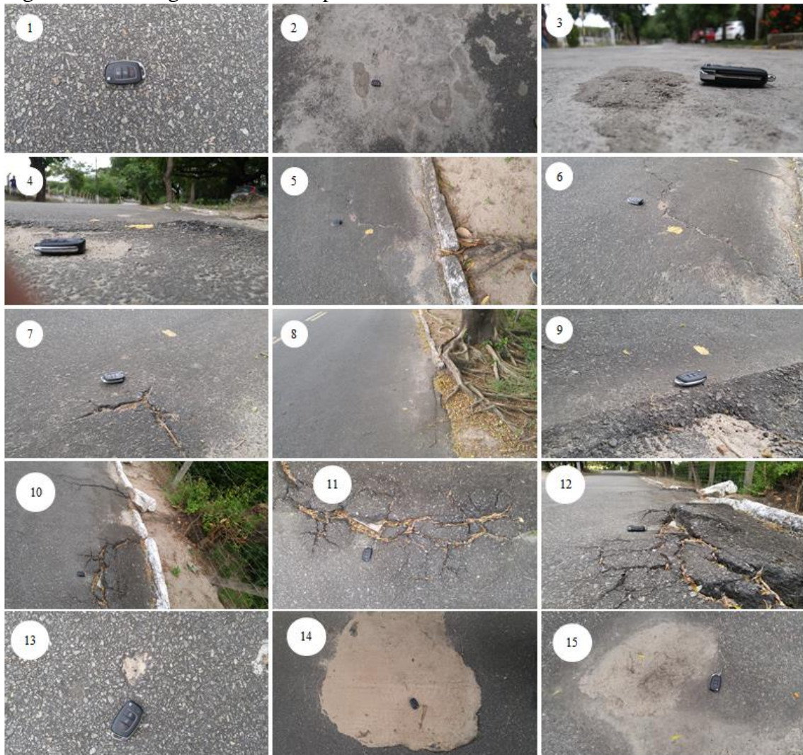
Figura 49 - Patologias do trecho experimental
